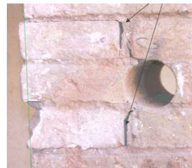
Fig. 2.307: Desplazamiento de los ladrillos existentes entre la perforación y el borde libre del pilastrón en el que se localizó el ensayo C-03 (Griera 2007).
