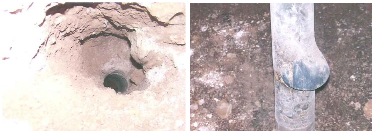
Fig. 2.308: Detalle de la presencia de un hueco interior en uno de los muros analizados.
