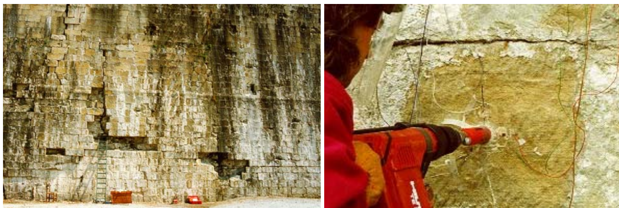
Fig. 2.229: Aspecto general de la zona de ensayo, se aprecia la carencia de sillares a ambos lados de la misma.
