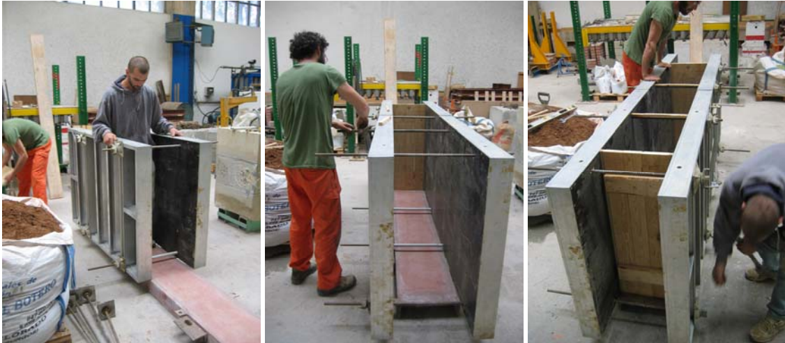
Fig. 4.5.32, 4.5.33 y 4.5.34: Proceso de montaje del encofrado sobre el perfil UPN rigidizado, soporte del tapial. Dicho elemento metálico permitirá, con posterioridad, el transporte del muro bajo el pórtico de ensayo. De la misma forma, puede apreciarse la disposición de los tapes laterales de madera.
