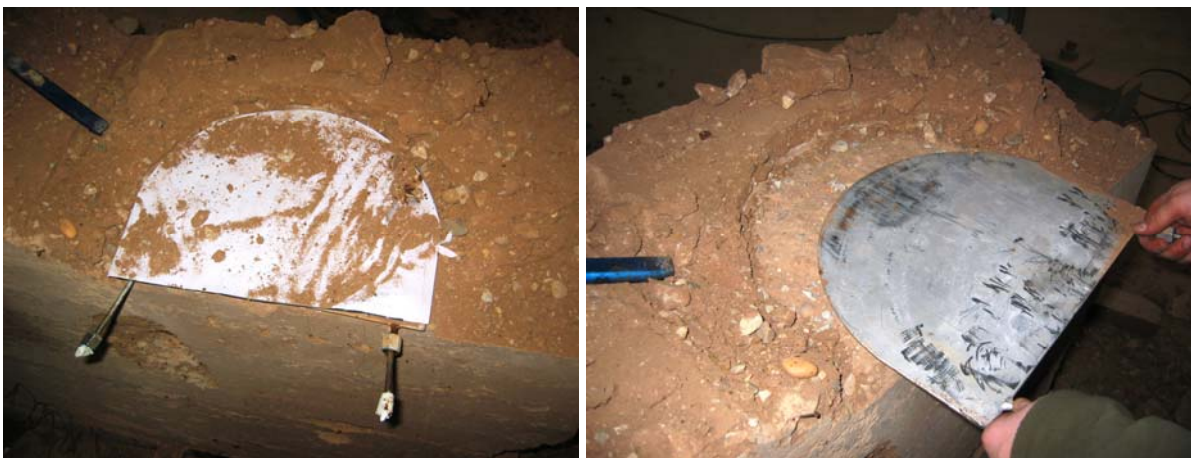
Fig. 4.5.167: Detalle de la posición del gato plano GPTap-Simple1 en fase de demolición del tapial.
