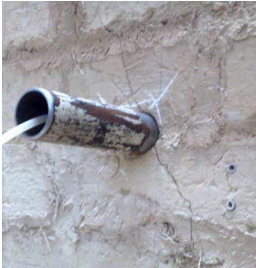
Fig. 4.6.84: Detalle general de la zona de ensayo una vez finalizado, puede apreciarse el agrietamiento radial a consecuencia de la presión introducida durante el ensayo mini-presurómetro DILAd2.
