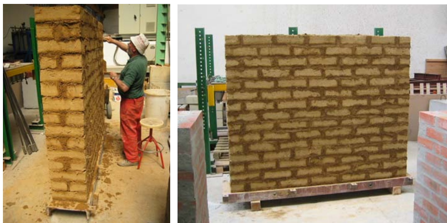
Fig. 4.6.6: Instante tomado durante el proceso de rejunteo del muro mediante la aplicación de la mezcla de trabajo en las llagas y tendeles.
