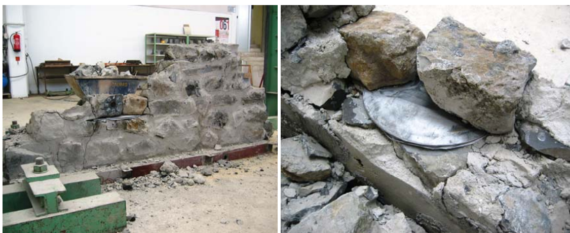
Fig. 4.2.115: Detalle de la posición del gato GPMD1-Inferior en una fase avanzada del proceso de demolición.
