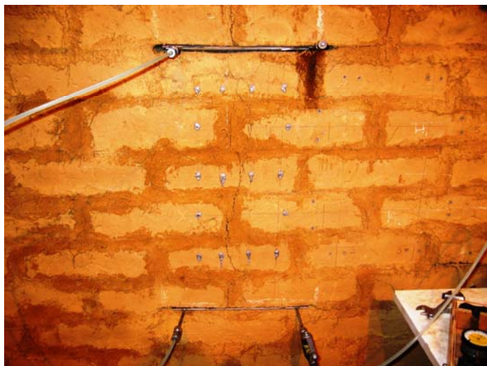
Fig. 4.6.57: Agrietamientos desarrollados en el área de ensayo a una presión instalada en los gatos de 14 bar (equivalente a una tensión sobre el muro de 1.02 MPa)
