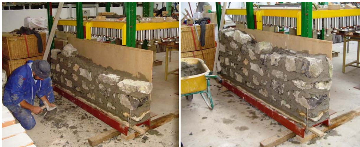
Fig. 4.2.2 y 4.2.3: Instantes tomados durante la construcción del muro de mampostería armado a base de roca caliza y mortero bastardo tipo M-20b, 1:2:10 (cemento:cal:arena, proporciones en volumen).
