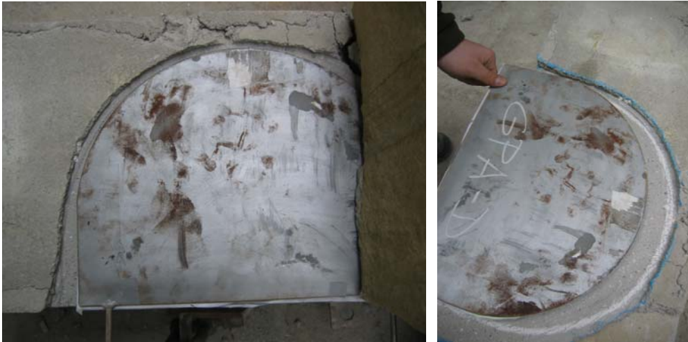
Fig. 4.1.256 y 4.1.257: Detalle de la posición relativa del gato plano GPS-A Inferior respecto de la roza.
