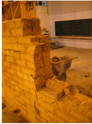
Fig. 4.6.106: Detalle de la posición del gato plano GPS-B-Inferior en fase de demolición del muro de adobe.
