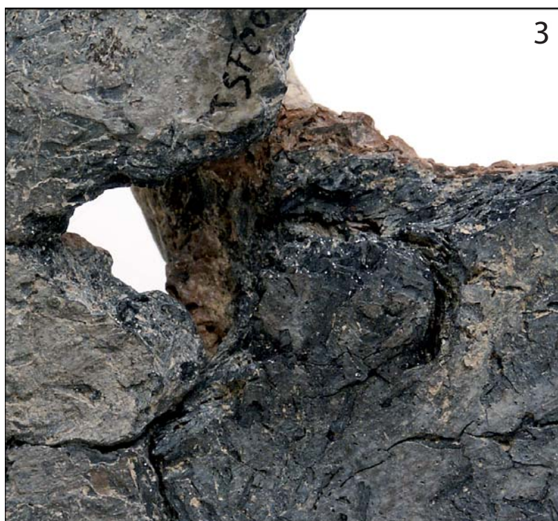
Grieta circular que evidencia la inserción del extremo del asas de cinta
