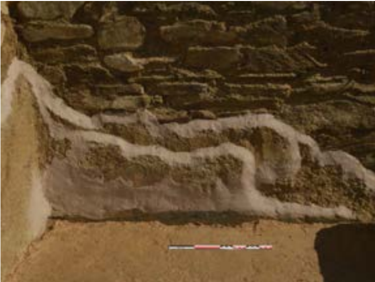
Figs. 276 i 277. Temple. Part septentrional de la cel·la. Mur lateral dret (ue 401) i cantonada nordest. Detalls del paredat i les diverses capes d'enlluït una vegada efectuada la seva consolidació. Any 2016
