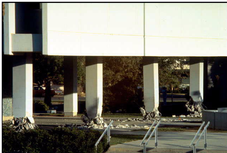
Figura 5.30. Fallo explosivo de las columnas del primer nivel - Sismo de Imperial Valley, (15 de octubre de 1979) ( http://nisee.berkeley.edu ).
