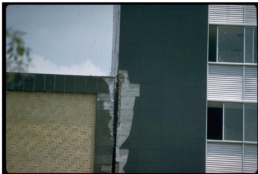
Figura 5.33. Daño producido por el impacto entre dos edificios de hormigón armado adyacentes, durante el sismo de México, 28 de Julio de 1957
