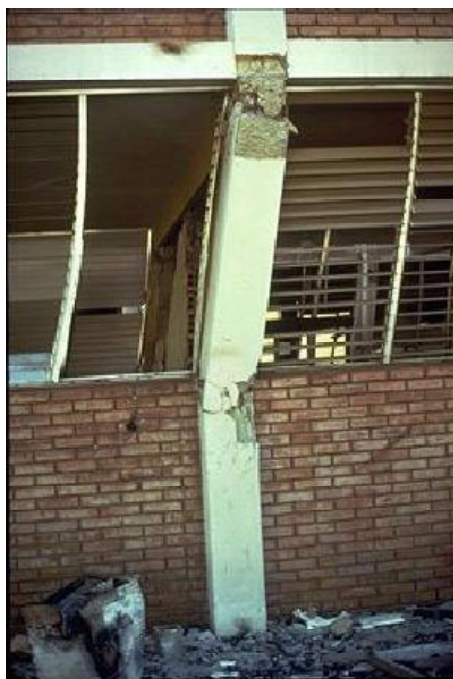
Figura 5.31. Fallo de "columna corta" producido por la mampostería de relleno y las ventanas ( http://nisee.berkeley.edu ).
