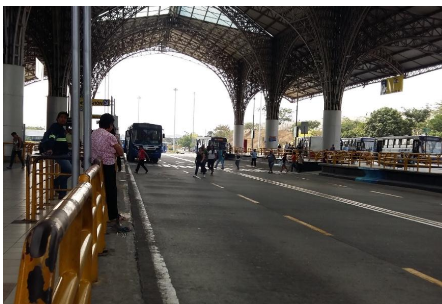
Imagen 198. Estado de las terminales piso, señalización y elementos de protección.
