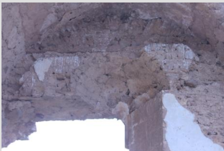
Fig.6.68. Negativo dejado por los ladrillos que formaban la bóveda y restos de aspillera
