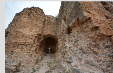
Fig.6.74. Entrada al castillo desprendimiento de piedras en esquina
