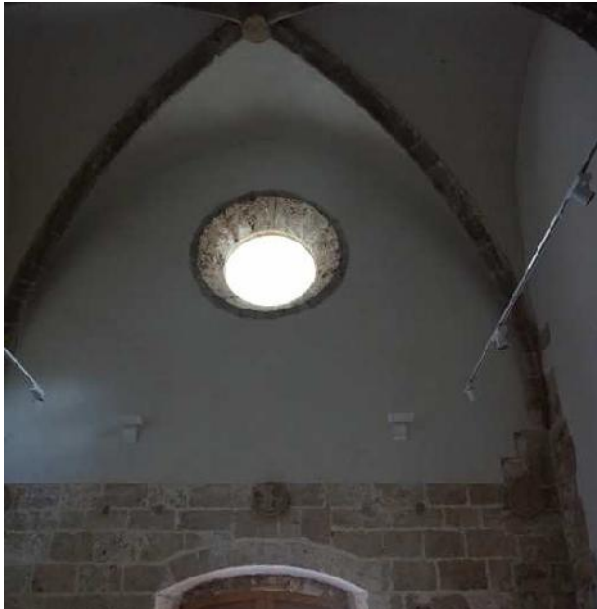
Fig. 4.15. Interior de la iglesia de San Martín. Cartuja de Vall de Cristo
