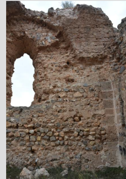
Fig.6.79. Caída reciente de esquina de la bóveda de la sala principal
