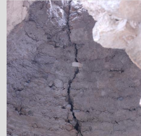
Fig.6.78. Grietas en cúpulas, sala glorietta
