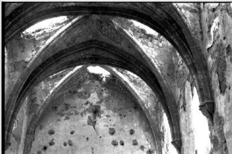
Fig. 1.15 Vista Bóveda de la Iglesia de San Martín, Cartuja de Vall de Cristo, antes de las restauraciones. Fotografía de José Manuel López Blay.
