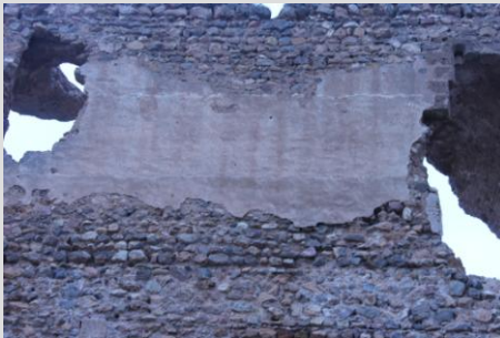
Fig.6.66. Cara exterior de los muros de la fachada restos de enfoscado y niveles de hiladas
