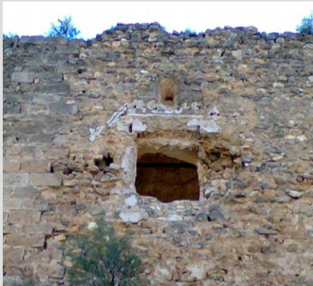
Fig.6.76. Pérdida de material en fachada, grietas y humedades, ausencia de reboco
