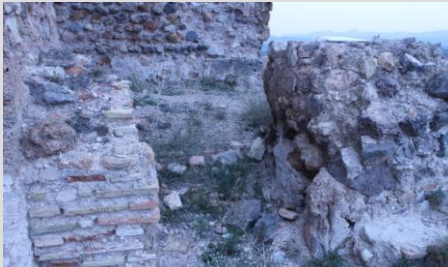
Fig.6.50. Restos de edificaciones adosadas al castillo junto a la sala de la cocina
