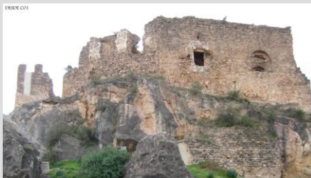
Fig.6.77. Fachada septentrional ausencia de revocos
