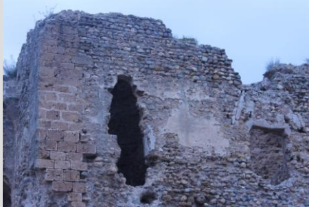
Fig.6.75. Perdas de materiales en fachada
