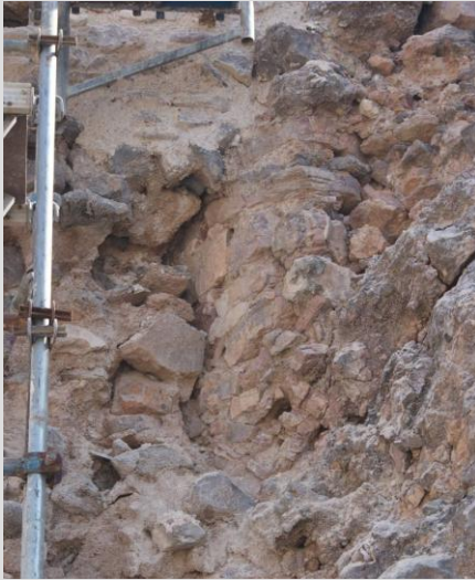
Fig.6.80. Consolidación de la Torre Norte donde se ve que el lienzo d la torre se apoya sobre el muro existente ,ya existía un primer recinto que fue remodelado a finales del siglo XII o principios del XIII y que sufriría más reformas en las etapas posteriores.
