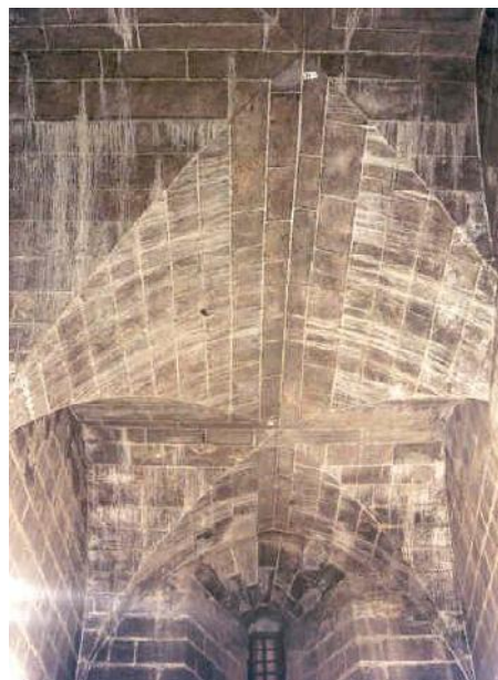
Fig.105 Bóvedas aristadas del Claustro de la Cartuja de Porta Coeli (Navarro Fajardo, JC. Bovedas Valencianas de Cruceñas de los siglos XIV al XVI. Traza y Montea)
