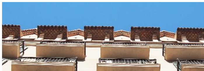
Ràfec "trencat" a la casa de Bernardí Martorell. Fotografia de l'autora (26-10-2017).
