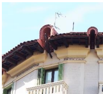
Detall de la part superior de la façana de la casa Pilar Serrahima. Fotografia de l'autora (26-10-2017).
