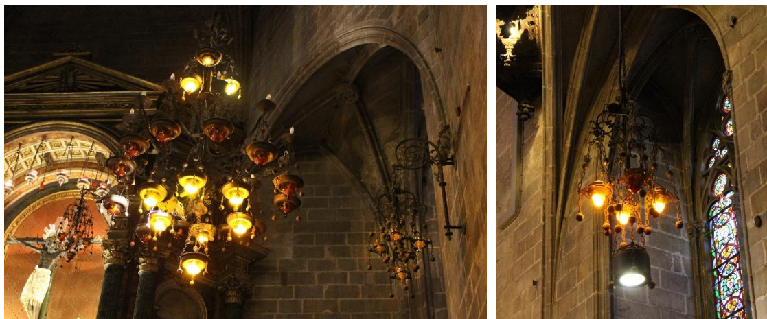
Sistema d'il·luminació de la capella del Sant Crist de Lepant. A la fotografia de l'esquerra es poden veure quatre elements: les llànties que pengen sobre el Crist, un dels dos llums que trobem a banda i banda de l'escultura, al mateix retaule, un dels llums grans que il·luminen l'espai i un dels laterals. A la dreta, un dels dos llums que il·luminen la part del posterior de la capella. Fotografies de l'autora (27-2-2019).
