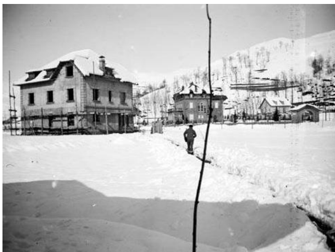
Xalets en construcció al nou passeig Maristany. Es pot veure, al fons, la casa Maristany acabada, i els arbres del passeig acabats de plantar. (s.d.). Fons: ACEC.
