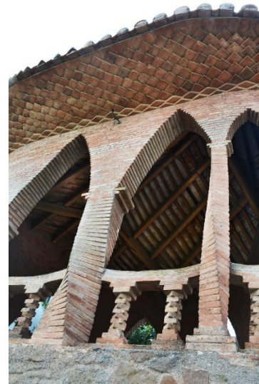
Detall de les columnes, balustrada, ràfec i estructura del sostre de la glorieta. Fotografia de l'autora (31-5-2018).
