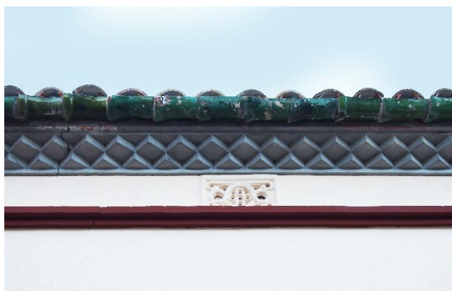
Detall del sospirall, ràfec i recollida d'aigües de l'edifici. Fotografia de l'autora (14-11-2017).
