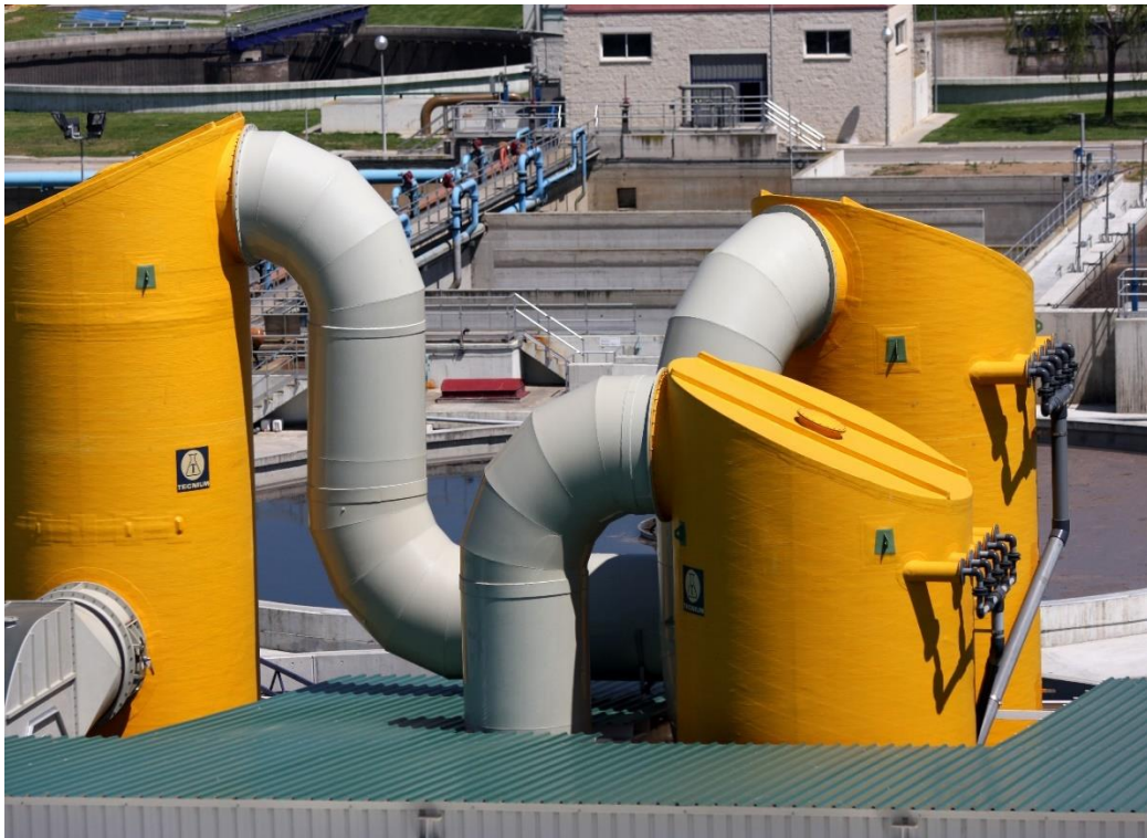
Figura 5. Instal·lació de tractament de l'aire (rentadors químics àcid i bàsic; humidificador)
