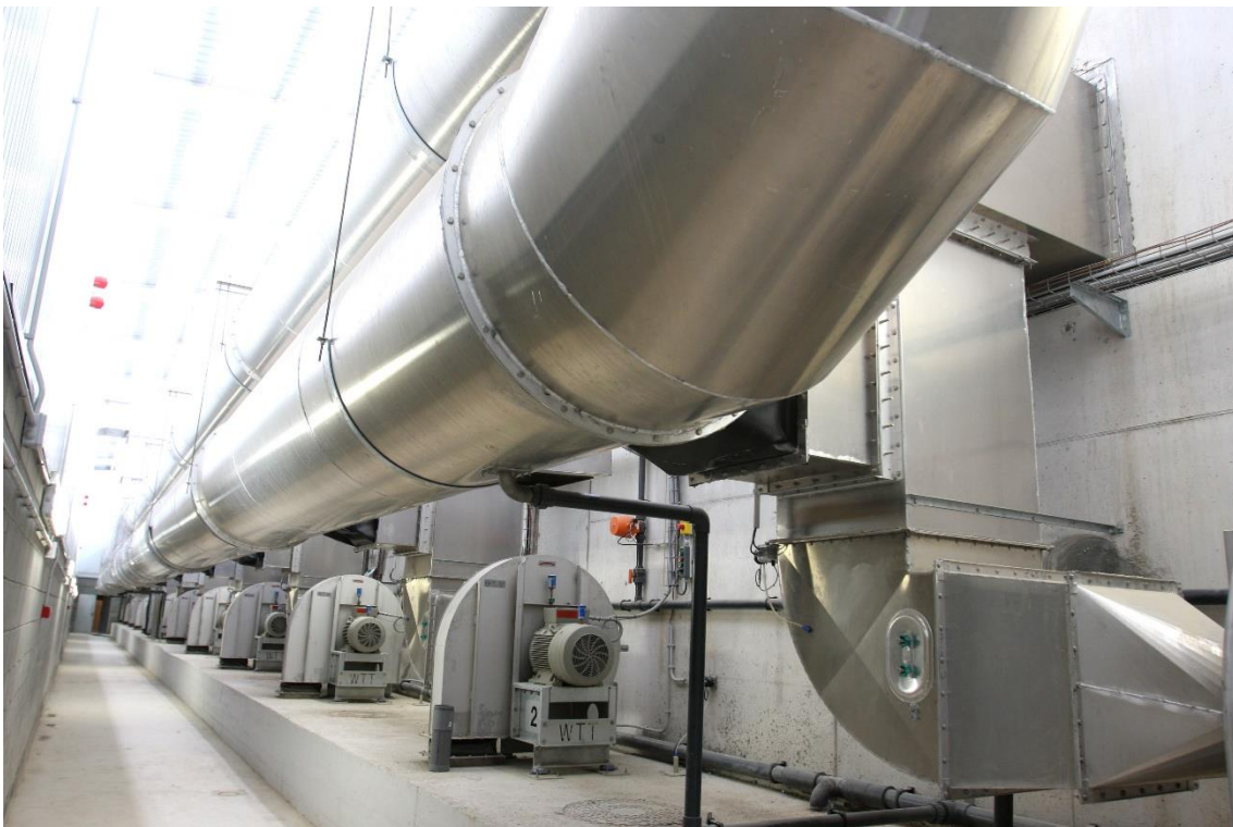
Figura 4. Galeria de ventiladors dels túnels de compostatge
