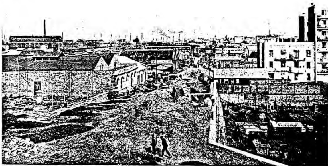
IL·LUSTRACIÓ 6. Obres del pas elevat del carrer Almogàvers a l'alçada del carrer Marina l'any 1928. (Font: Memòria de la Comisión Especial de Ensanche, 1928)
