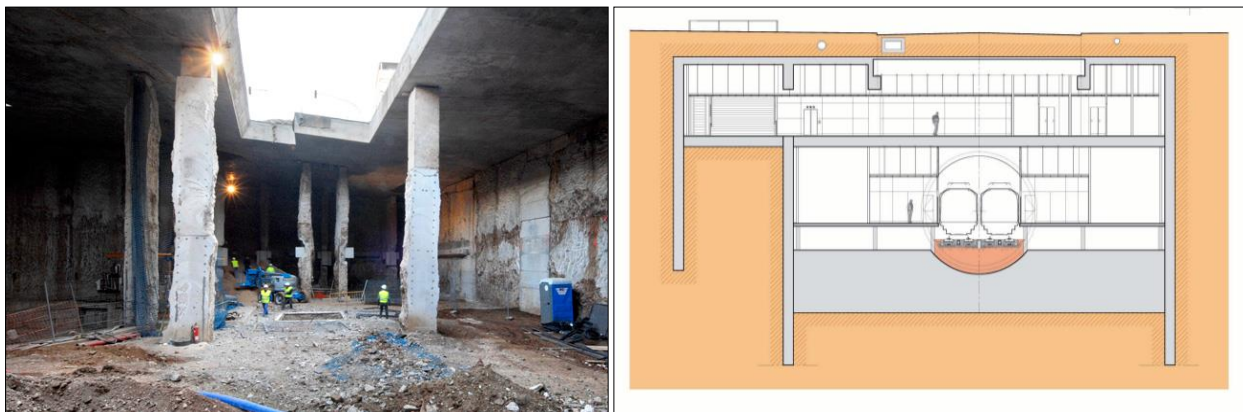
Figura 3.12. a) Obras en una de las estaciones del tipo convencional de la Línea 9 b) Estación subterránea convencional del Gorg en el Tramo IV
