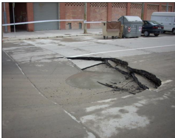
Figura 4.69. Hundimiento de la calzada por el paso de la tuneladora a la salida de la estación de San Cosme
