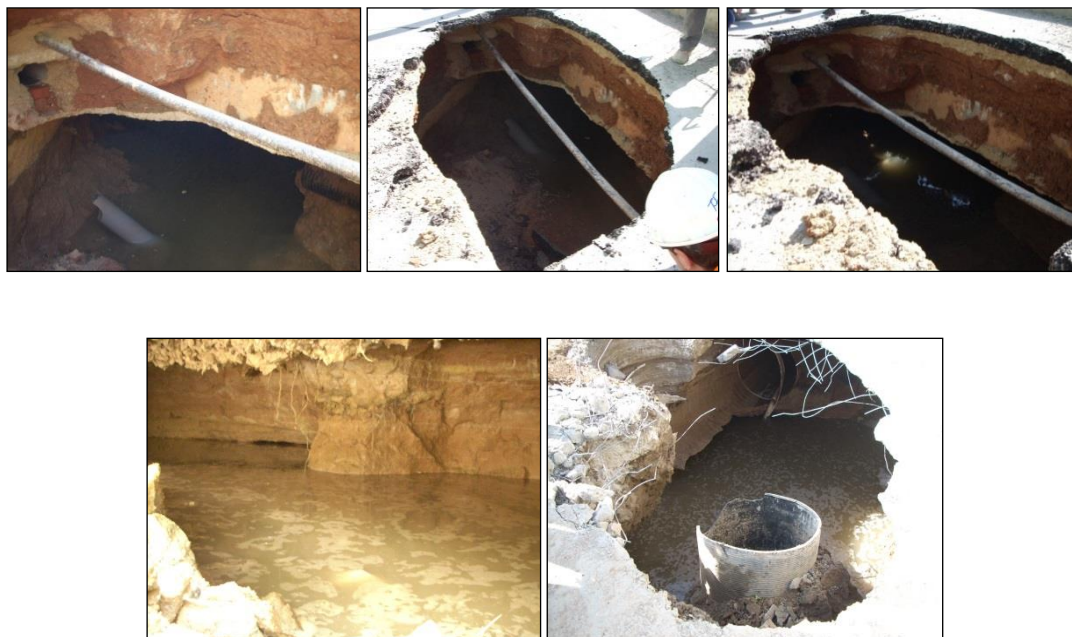
Figura 4.76. Fotos del socavón a la salida de la estación de Mas Blau
