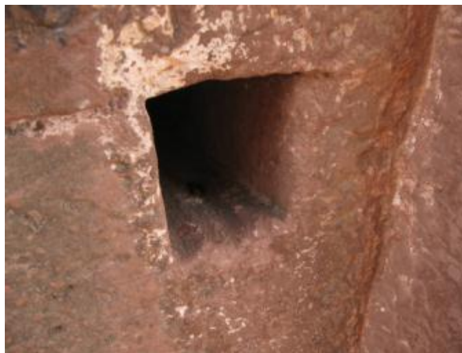
Figura 48. Forat a l'intradós del marc de la porta principal amb desgast per abrasió de la banda inferior degut al sistema de tancament de la porta de l'església.
