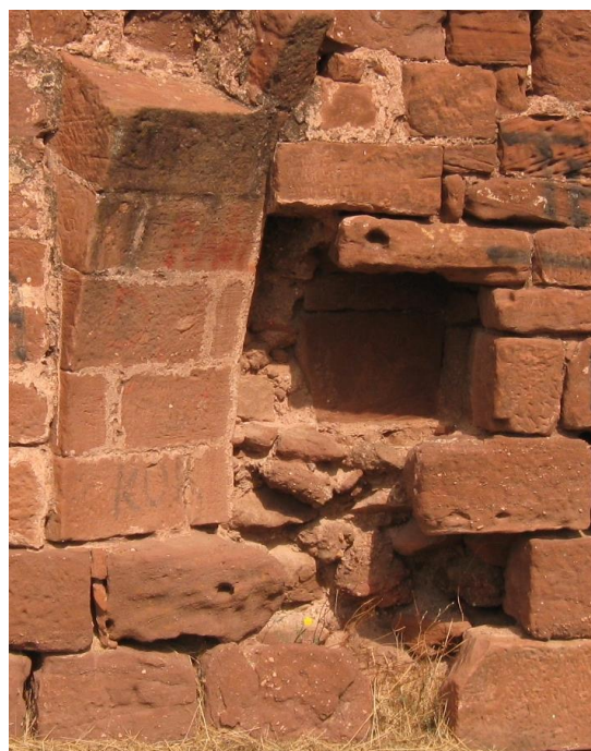
Figura 145. Segons figura en el projecte d'intervenció realitzat, l'espai per a dipositar material litúrgic situat a l'extrem est del mur sud de l'església ja no és visible com ho era quan es va obtenir aquesta imatge.
