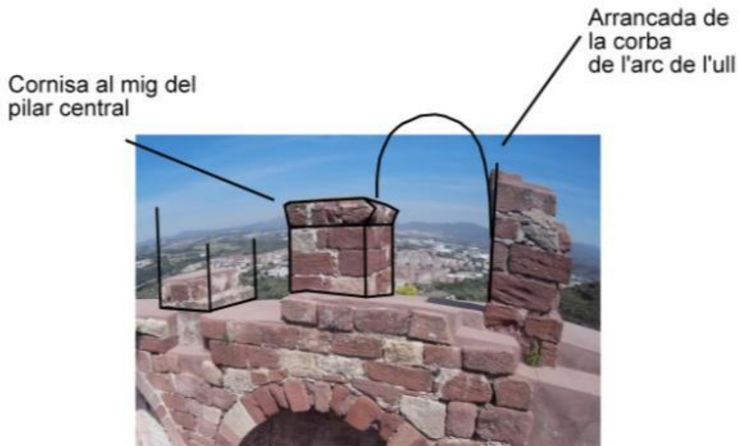
Figura 40 Interpretació d'estructures a la façana nord. Imatge Jordi Lozano.
