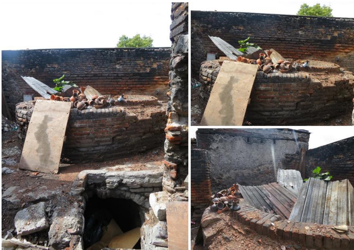
Imagen 132. Estado actual del horno de más de 300 años de la Asociación de Alfareros de La Luz posterior a las afectaciones del sismo del 19s. Fuente: Fotografías personales (2018).
