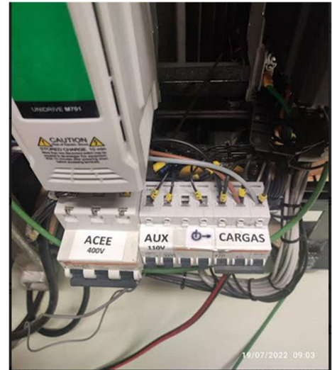
Fig. 160: Magnetotérmicos de puesta en marcha del (ACEE). Fuente: Propia
