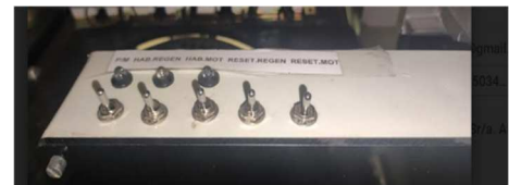
Fig. 161 : Interruptores de Habilitación y Reset del (ACEE). Fuente: Propia
