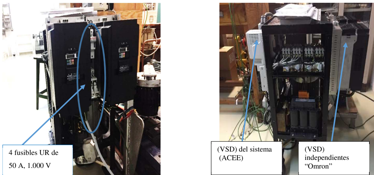
Fig. 166: Montaje de dos convertidores de frecuencia marca Omron de 11/15 kW, alimentados del bus DC del sistema regenerativo (ACEE). Fuente: Propia
