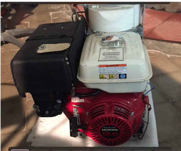
Fig. 61: Grupo electrógeno \cos\phi=0,5 , HONDA 4,6 kW- 8,5 kVA (conjunto máquina térmica alternador), RAS. Fuente: Propia
