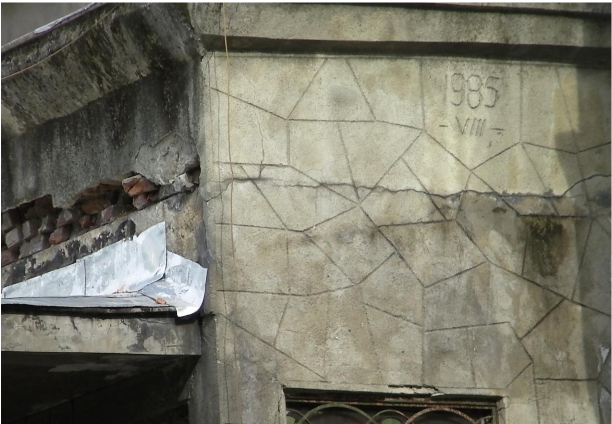
Detalle de la imagen anterior, donde se puede apreciar su sorprendente fecha de edificación (visto el estado de deterioro).
