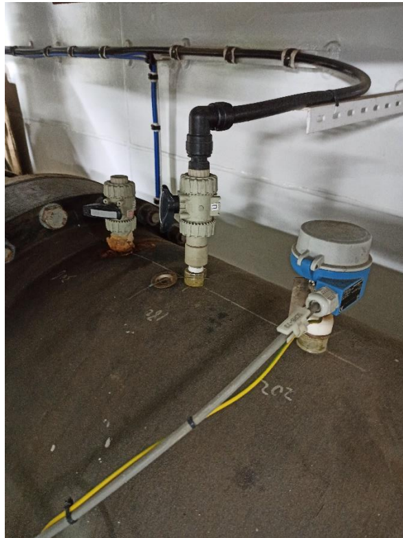
Figura 43. Vista de la línea de descarga de un SLGE de tipo híbrido instalado a bordo de un buque tipo portacontenedores con vista de los sensores para la monitorización de parámetros. Fuente: el Autor.
