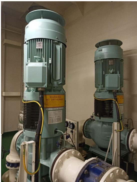
Figura 35. Vista de las bombas de aspiración de agua de mar de un SLGE de tipo híbrido instalado a bordo de un buque tipo portacontenedores. Fuente: el Autor.
