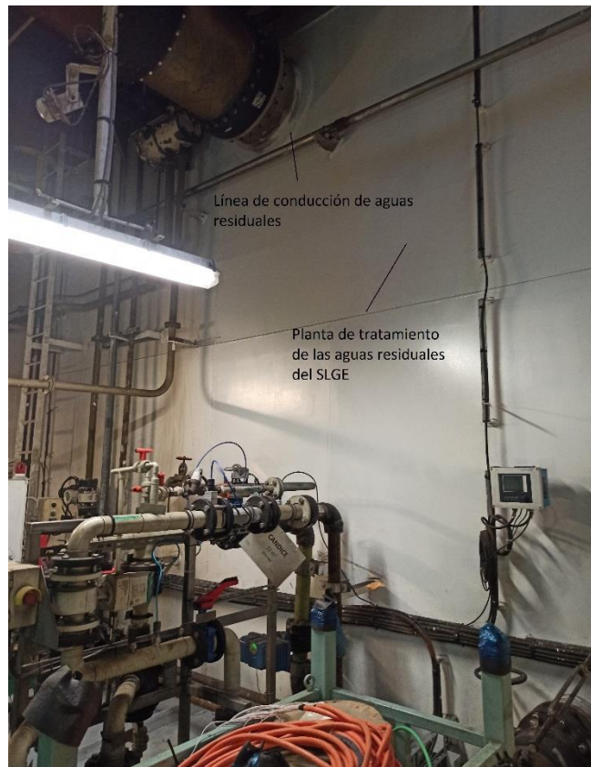
Figura 41. Vista de la planta de tratamiento de las aguas residuales de un SLGE de tipo híbrido instalado a bordo de un buque portacontenedores con detalle de la línea de conducción de las aguas residuales y su entrada a la planta de tratamiento. Fuente: el Autor.
