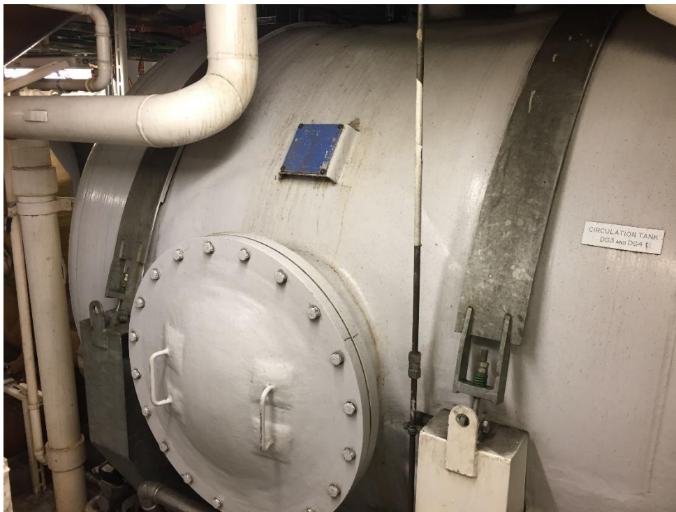
Figura 30. Vista del tanque de recirculación de un sistema de limpieza de los gases de escape de ciclo cerrado instalado a bordo de un buque tipo crucero. Fuente: el Autor
