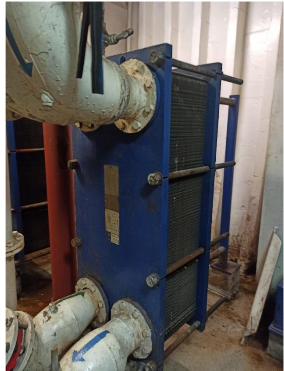
Figura 40. Vista del intercanviador de calor amb detall de la línia d'entrada d'aigua de lavado residual calent (negre) i sortida (blau) d'un SLGE de tipus híbrid instal·lada a bord d'un buque tipus portacontenedores. Fuente: el Autor
