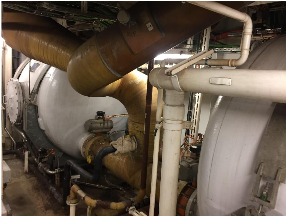
Figura 31. Vista de la entrada del agua residual de lavado a los tanques de recirculación de un sistema de limpieza de los gases de escape de ciclo cerrado instalado a bordo de un buque tipo crucero. Fuente: el Autor
