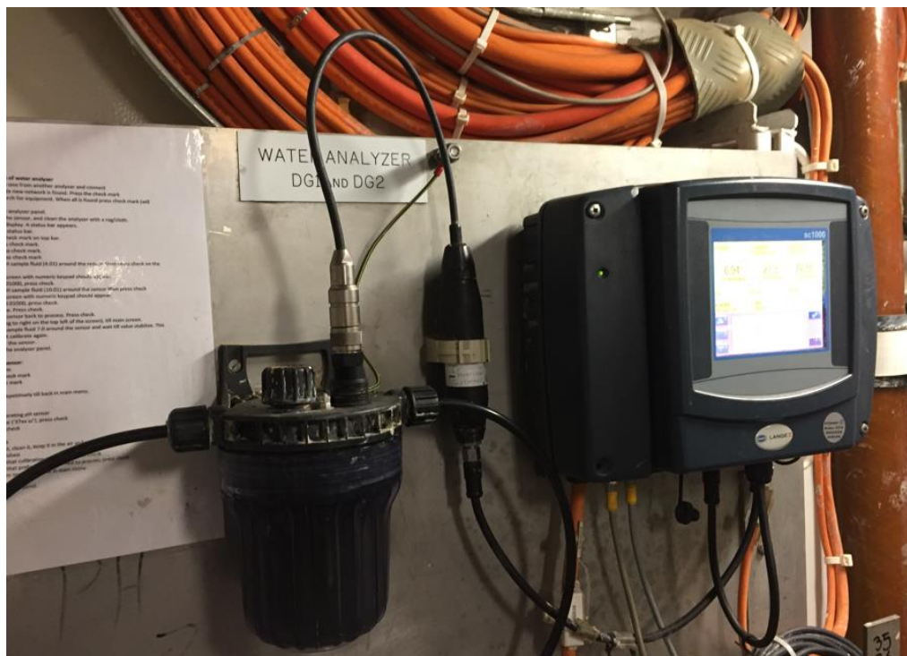
Figura 33. Vista de uno de los sensores que compone el sistema de monitorización de los parámetros del agua de lavado en un EGCS de ciclo cerrado instalado a bordo de un buque tipo crucero. Fuente: el Autor.
