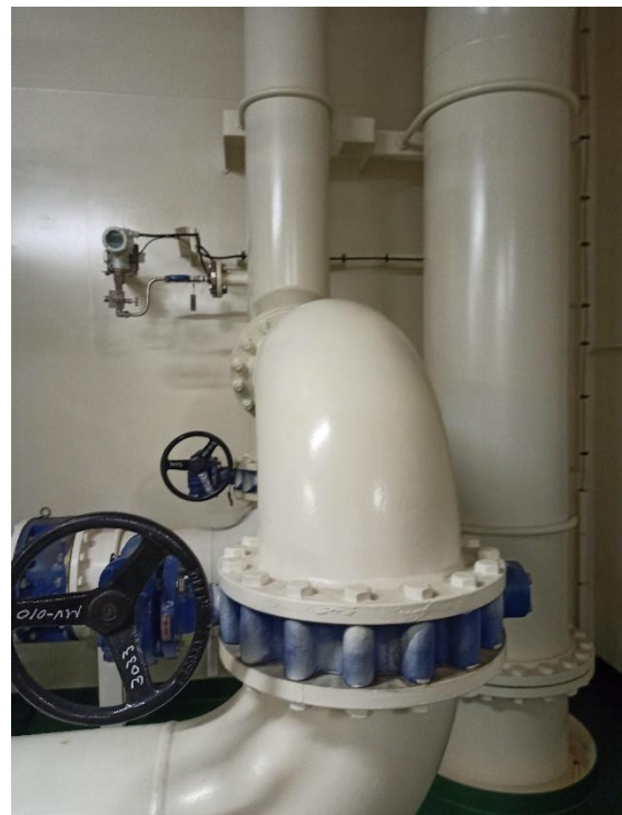
Figura 36. Vista de las válvulas y líneas de conducción primarias del agua de mar captada por las bombas de aspiración en un SLGE de tipo híbrido instalado a bordo de un buque portacontenedores. Fuente: el Autor.
