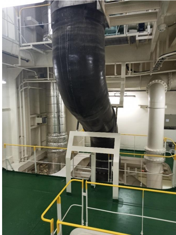
Figura 38. Vista de la línea de conducción del agua de lavado residual hacia la planta de tratamiento, de un SLGE de tipo híbrido instalada a bordo de un buque portacontenedores. Fuente: el Autor
