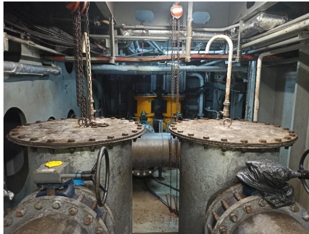
Figura 17. Vista de las válvulas, bombas de aspiración y líneas de entrada de agua de mar del sistema de limpieza de los gases de escape de ciclo abierto instalado a bordo de un buque tipo ropax. Fuente: el Autor.
