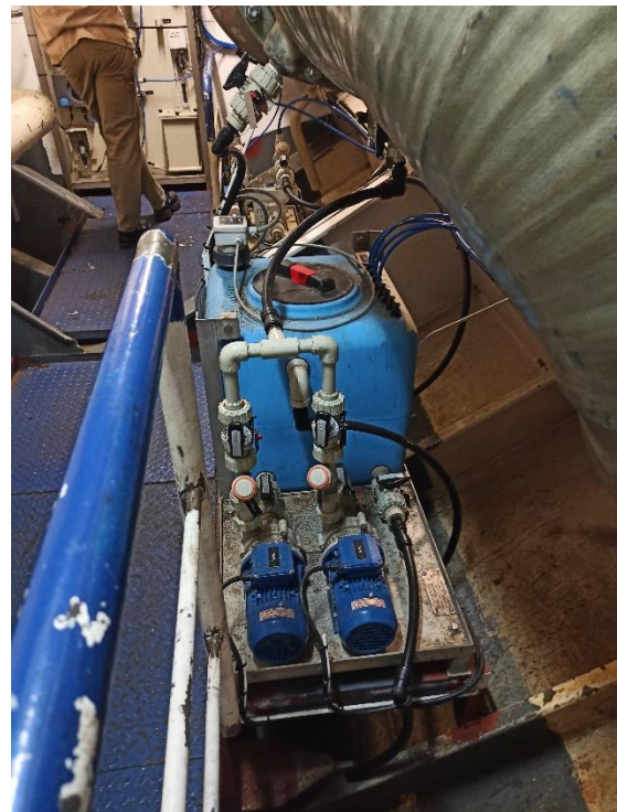
Figura 22. Vista del sistema de muestreo y análisis por los sensores de los parámetros del agua de lavado de un EGCS instalado a bordo de un buque tipo ropax. Fuente: el Autor.
