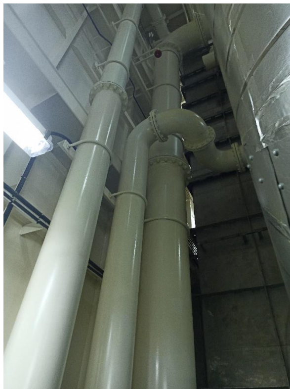
Figura 37. Vista de las líneas de conducción del agua de mar y su conexión a la torre de lavado de un SLGE de tipo híbrido instalada a bordo de un buque portacontenedores. Fuente: el Autor.
