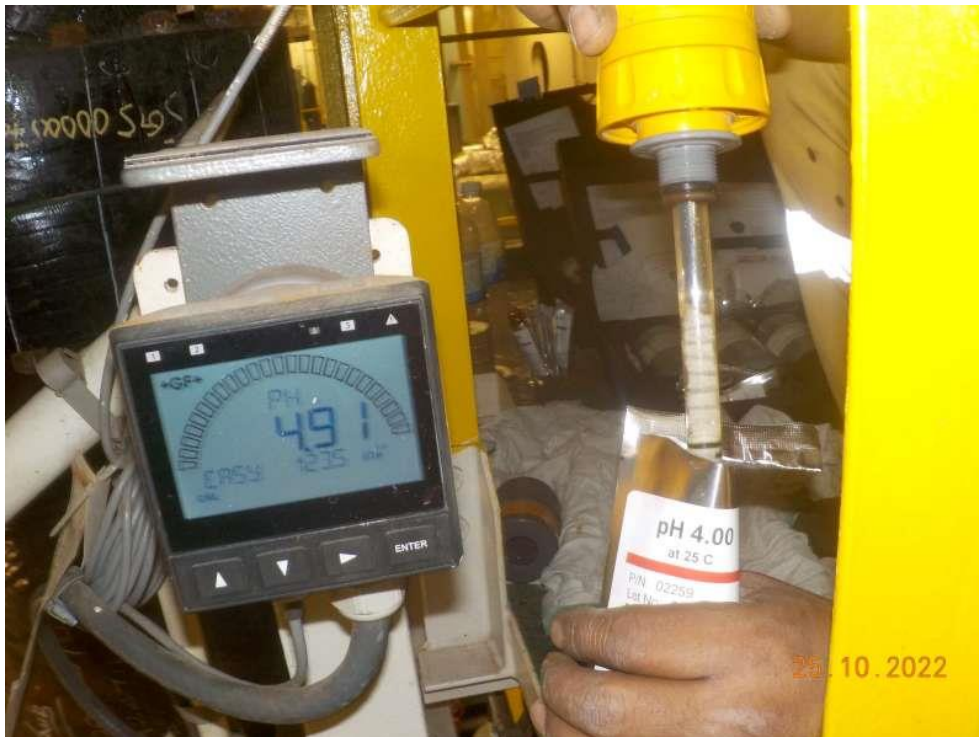
Figura 46. Vista del proceso de calibración de un sensor de pH (acidez) de un SLGE de tipo híbrido instalado a bordo de un buque portacontenedores. Fuente: el Autor.
