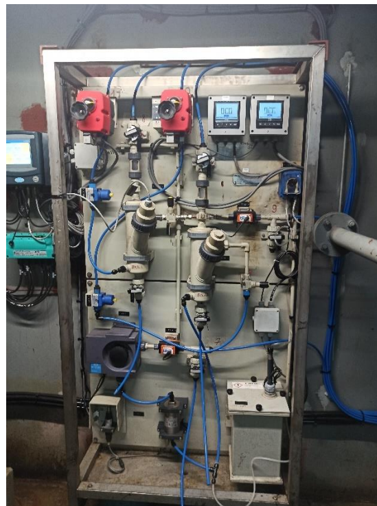
Figura 18. Vista del conjunto de sensores de monitorización de los parámetros de agua de mar a su entrada en el sistema de limpieza de los gases de escape de ciclo abierto instalado a bordo de un buque tipo ropax. Fuente: el Autor.
