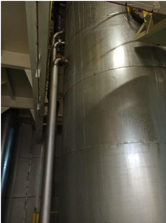
Figura 19. Vista de las líneas de conducción del agua de mar hasta la torre de lavado. Fuente: el Autor.
