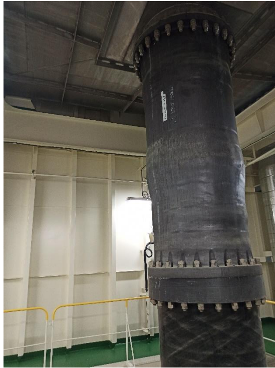
Figura 85. Vista del área existente bajo la torre de lavado de un SLGE de ciclo abierto. Fuente el Autor
