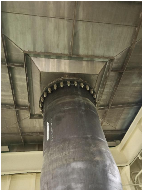
Figura 21. Vista de la base de la torre de lavado y conducto del agua residual de un EGCS instalado a bordo de un buque tipo ropax. Fuente: el Autor.
