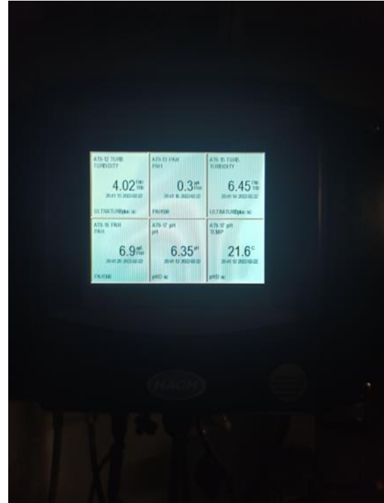
Figura 27. Vista de los valores de los parámetros del agua de lavado previo a su descarga en un EGCS instalado a bordo de un buque tipo ropax. Fuente: el Autor.
