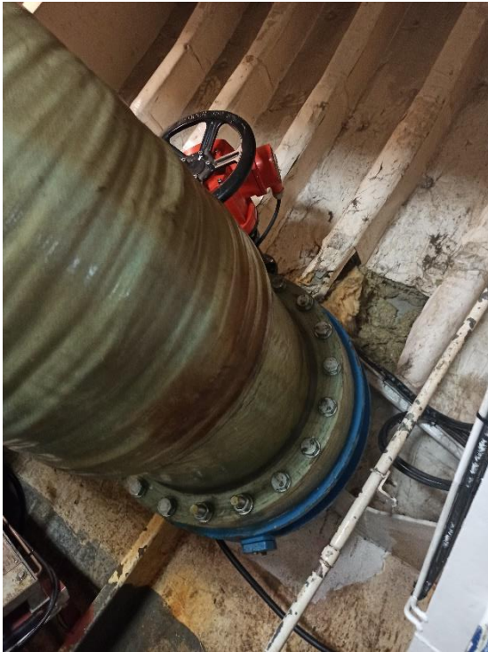
Figura 26. Vista del conducto y válvula de descarga del agua residual de un EGCS instalado a bordo de un buque tipo ropax. Fuente: el Autor.
