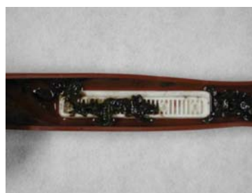
Figura VI 24. Vista del estado del lateral y gotero del final del lateral que operó con el efluente secundario filtrado con un filtro de anillas al acabar el ensayo.
