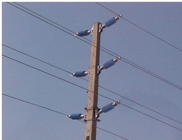
fig. 9.10 Apoyo circuito MT, Catalunya, completamente equipado con aisladores poliméricos. Cortesía de ENDESA Distribución Eléctrica.
