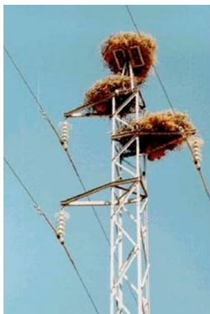
fig. 9.1 Triple nido de cigüeñas en apoyo circuito MT Catalunya. ENDESA Distribución Eléctrica.
