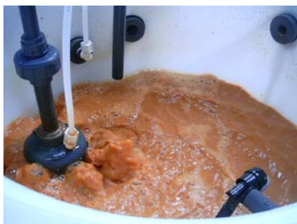
(a) Tanque de ultrafiltración
