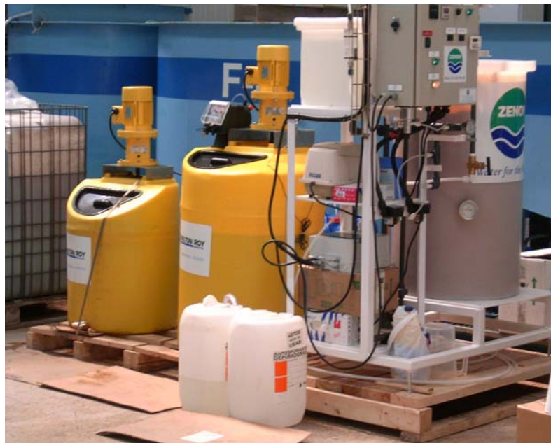
Figura 4.8. Planta piloto empleada en el tratamiento de lixiviados.
