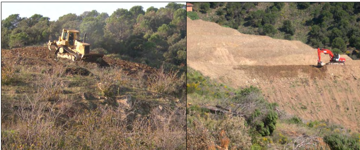
Figura 1.4. Treballs de preparació del terreny per a la plantació de vinya aterassada a la finca Les Foreses, Porrera (DOQ Priorat).
