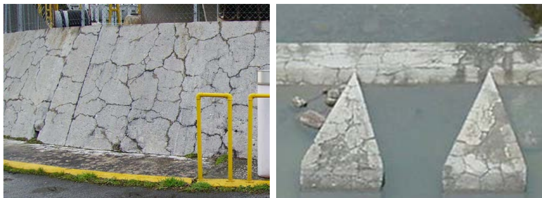
Figura 2.16 – Fisuración mapeada en estructuras auxiliares de la presa de Belesar debido a la RAA (izquierda) y en la presa de Tavàscan debido al ASI (derecha).
