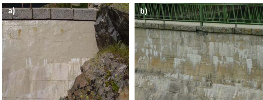
Figura 2.19 – Fisuras en paramentos de las presas de Rumedo (a) y Torán (b) (Araújo, 2008).
