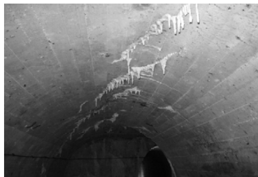
Figura 2.18 – Fisuras inclinadas en la galería superior de la presa de Paso Nuevo (Espinós et al., 2010).
