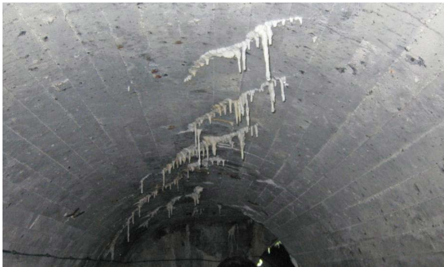
Figura 6.6 – Fisuración oblicua en la galería a cota 1350 m cerca de la junta 11.
