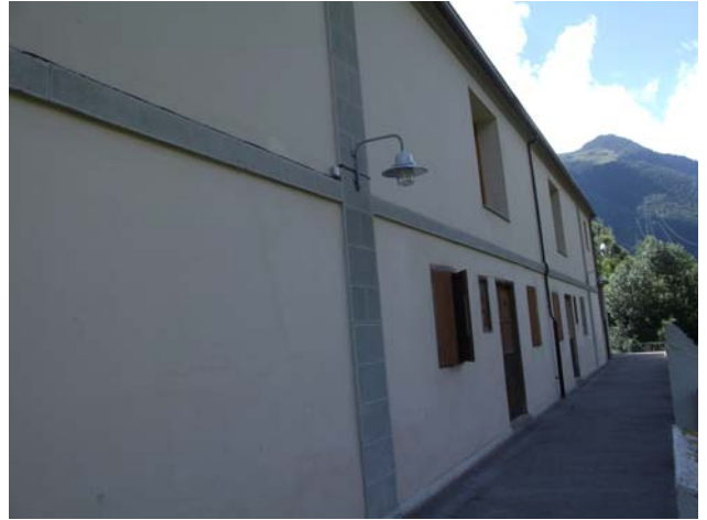
Foto 29_1-8 Detalle de pilar y falsos techos
