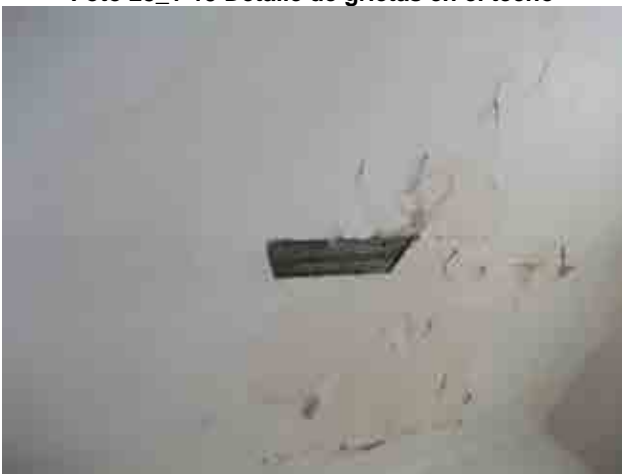
Foto 28_1-17 Detalle de grietas en el techo y ubicación de vigas
