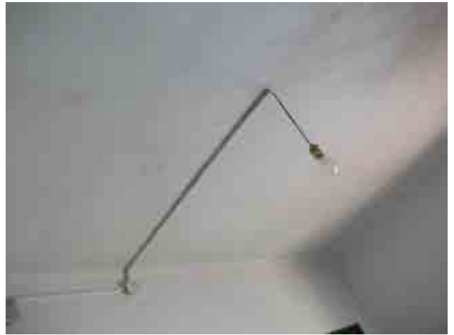
Foto 28_1-16 Detalle de grietas en el techo
