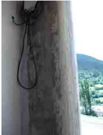
Foto 25_1-21 Detalle de fisuras en los pilares de apoyo del pasillo
