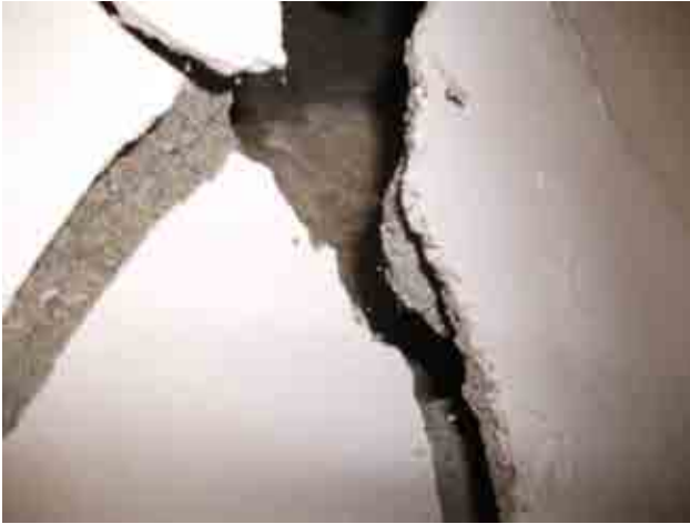
Foto 28_1-13 Inspección de grietas y daños en el edificio para identificar materiales
