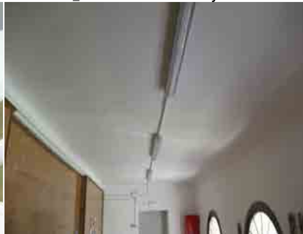
Foto 23_1-18 Detalles del techo y fisuras
