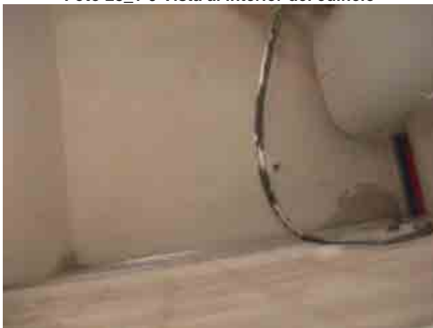
Foto 28_1-11 Inspección de falsos techos. Verificación de forjados y material de los muros
