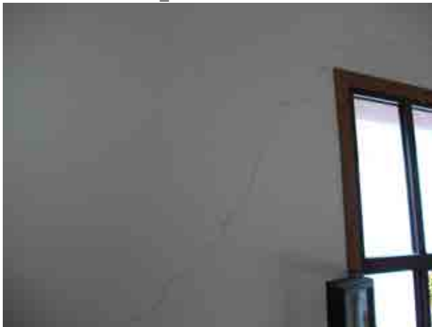
Foto 35_1-9 Detalle de fisuras
