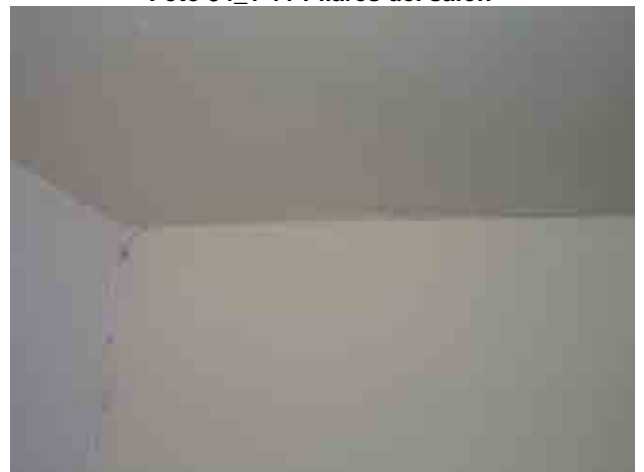
Foto 34_1-13 Grietas en las conexiones de los muros del salón
