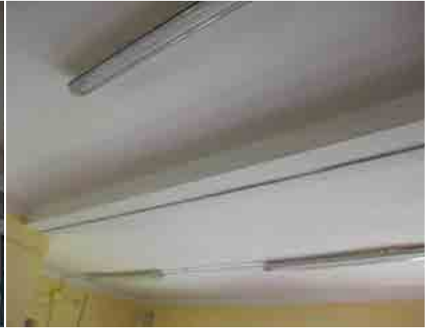
Foto 23_1-20 Detalles del techo y fisuras
