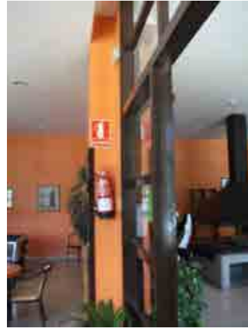
Foto 25_1-8 Detalle de pilar y falsos techos
