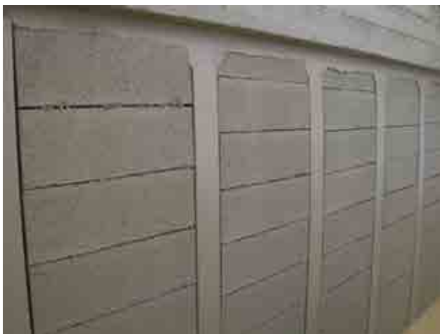
Foto 26_1-3 Forjados en las entradas del edificio
