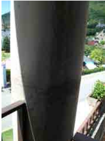
Foto 25_1-22 Detalle de fisuras en los pilares de apoyo del pasillo
