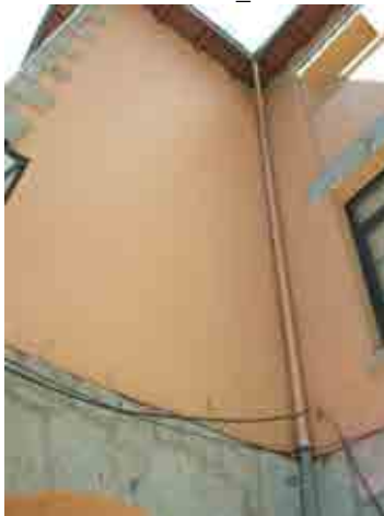
Foto 28_1-3 Forjados en las entradas del edificio
