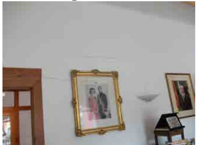
Foto 35_1-10 Detalle de fisuras
