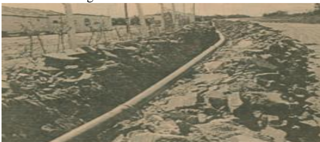
Figura 58 – Passagem de tubulação para o sistema de abastecimento de água do NSA.
