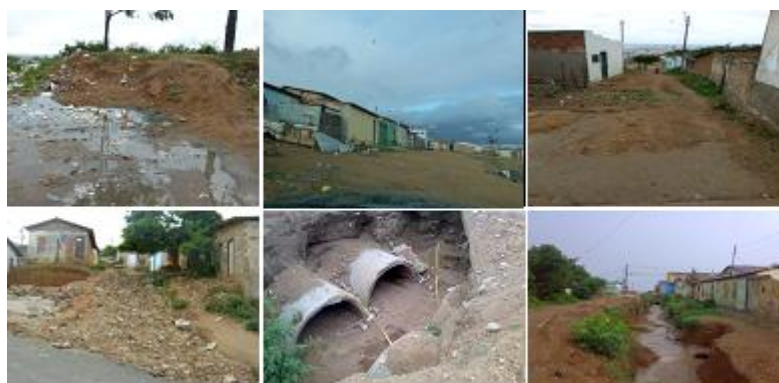
Figura 148 – Fotos de problemas com drenagem em ruas do bairro
