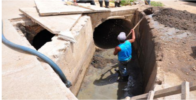
Figura 79 – Canal de drenagem do NSA
