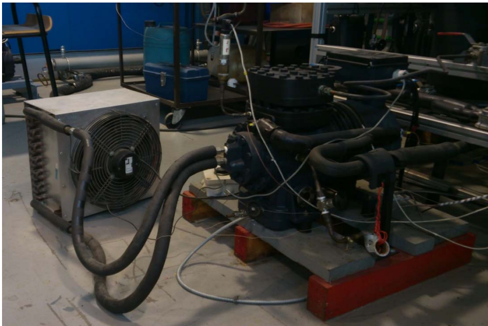
Figura 5.5.- Aerorefrigerador de aceite.
