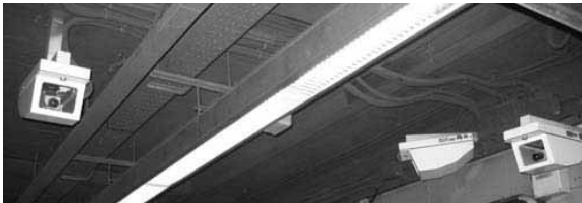
FIGURA 1 Cámaras de vigilancia
