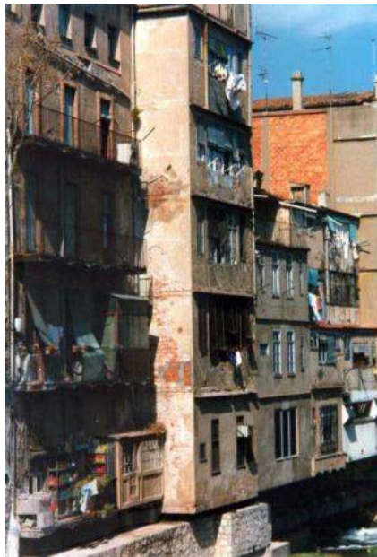
Fig. 8 (izq.). Fachadas hacia el río Onyar, lado poniente, con un alto índice de degradación.
