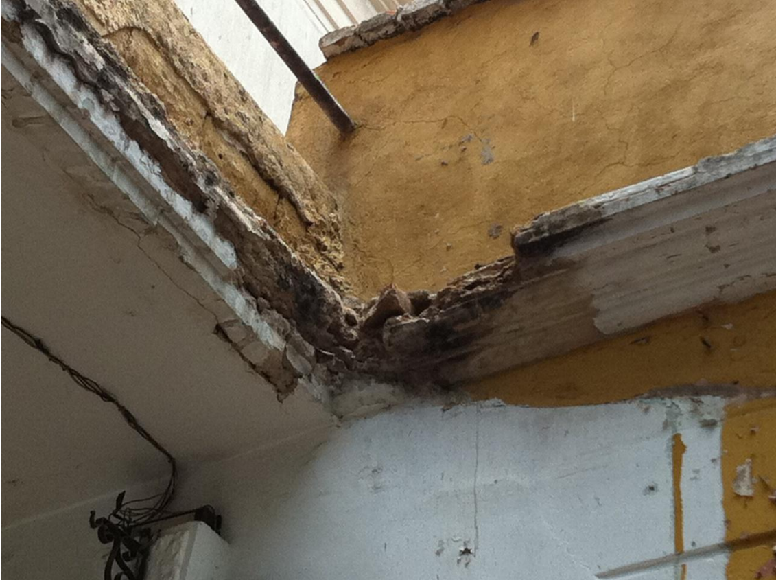
4.75 En esta fotografía se ve la moldura deteriorada con su base de ladrillo. Hidalgo 1291.
