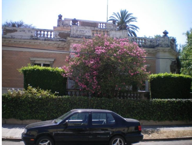
4.17 Una parte significativa de pretilas han perdido su enjarre en la casa de Vallarta 1122
