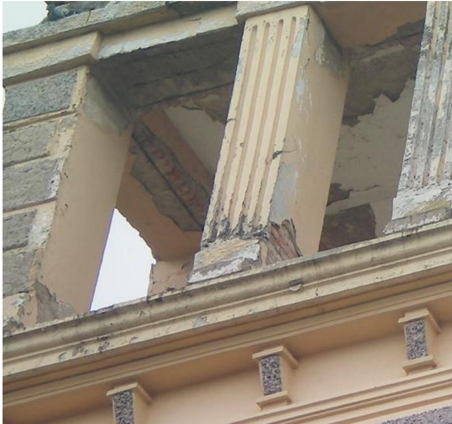
4.55 Detalle del ladrillo en la parte inferior del pilar. Francia 1359.
