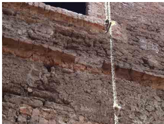
4.74 Detalle de la cornisa hecha con ladrillos colocados en perpendicular y dispuestos a recibir el enjarre. Hidalgo 1291.
