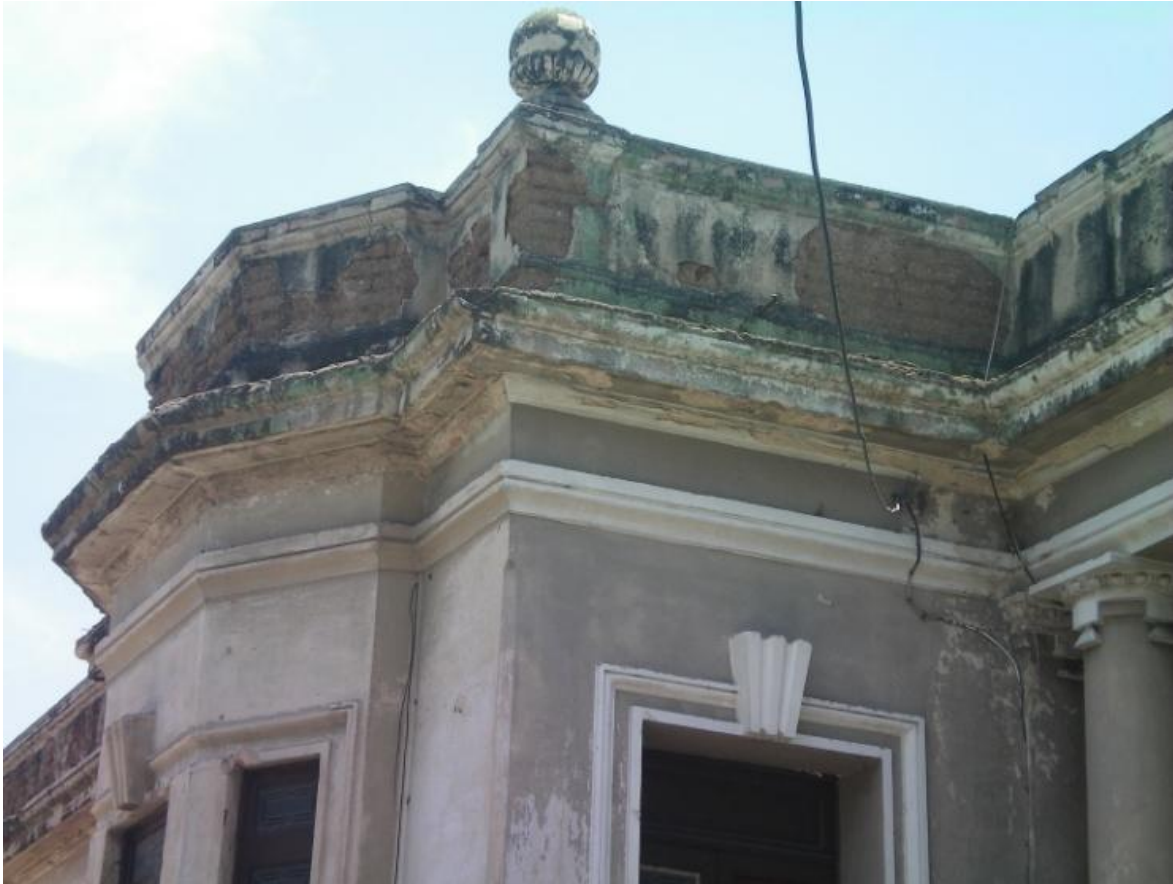
4.14 Casa de la Av. Vallarta 1581. El desprendimiento del enjarre permite observar los adobes que constituyen el pretil superior
