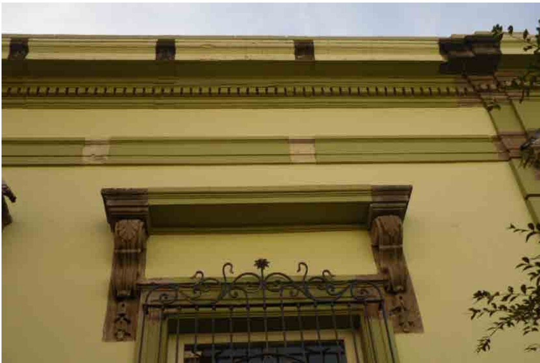
4.69 Ver las esquinas de la moldura y las ménsulas de cantera. Calle Liceo 177.
