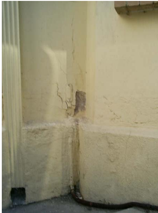
4.99 Detalle de la boca del bajante a nivel de calle en Libertad 1966
