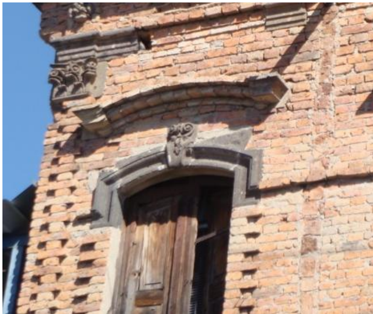
4.62 Detalle de los arcos rebajados en las ventanas de una casa en Mezquitán 842
