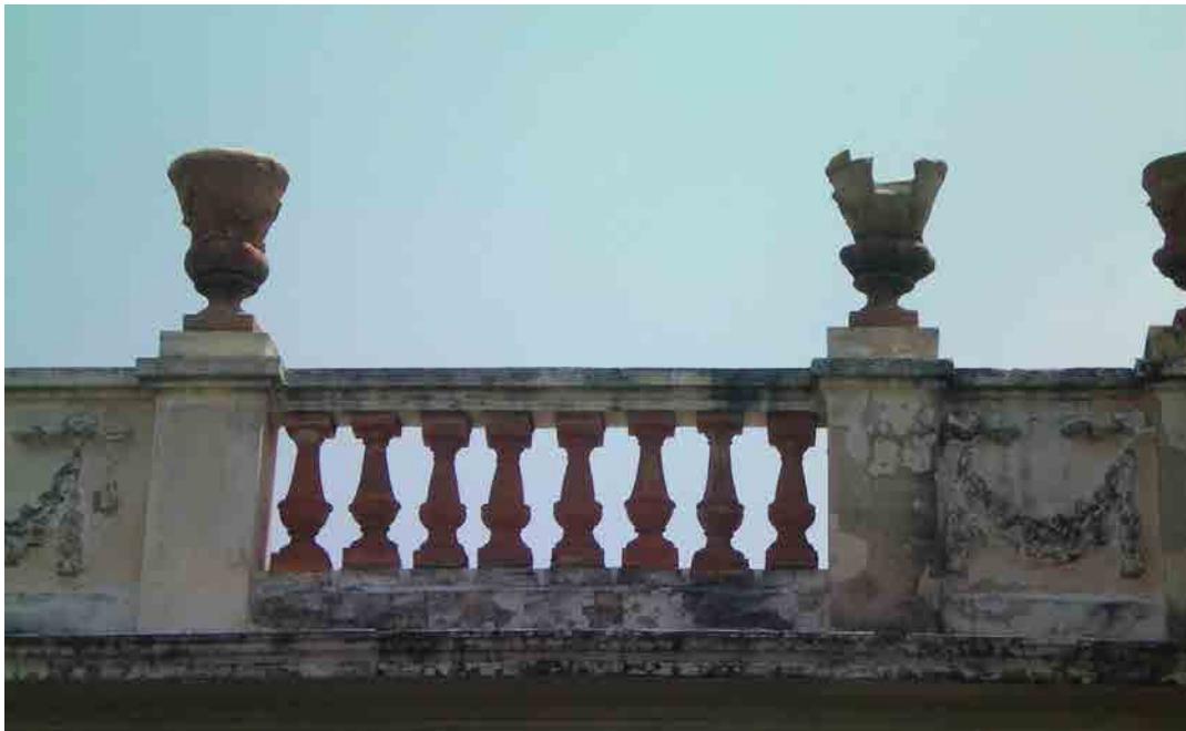
4.79 El florón de la derecha, al estar roto, deja ver el material cerámico con el que está hecho. Casa de los Abanicos, Libertad 1823.
