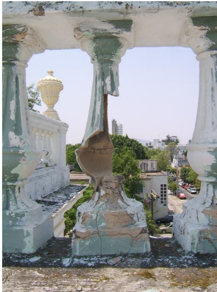
4.81 Detalle de balaustre de barro fracturado. Hidalgo 1346.
