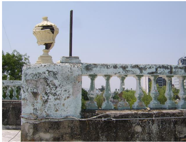
4.80 El jarrón está quebrado y se sostiene por un entramado de alambre interno.
