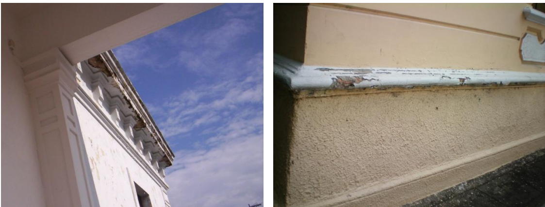
4.76 Izquierda, detalle de la cornisa superior en la casa de Libertad 1823. Derecha, detalle del basamento en Pedro Moreno 1299.
