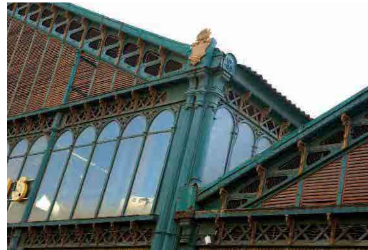
Fig. 548 Actualmente pueden apreciarse los efectos del óxido en los diferentes elementos que conforman la fachada. Foto: Autora
