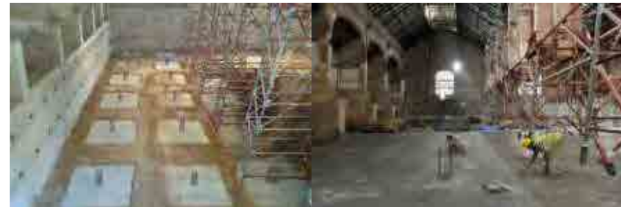
Fig. 673 Imágenes del proceso de las obras, tomada de la exposición sobre las mismas exhibida en el mercado provisional de Sants en 2011.
