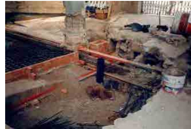
Fig. 347 Trabajos en las bóvedas de la pescadería, 1990. Foto: tomada de la tesis doctoral de Francisco Hidalgo. 96
