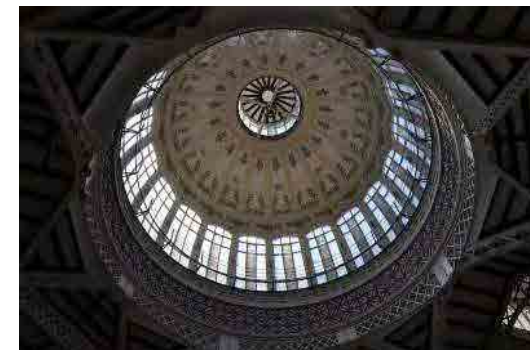
Fig. 353 Imágenes que muestran la gran variedad de materiales del edificio, tomadas después de los trabajos de rehabilitación. Fotos: Flickr tonogayora
