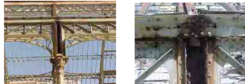
Fig. 419 Detalles de la oxidación en la estructura. Fuente: Informe AUMSA
