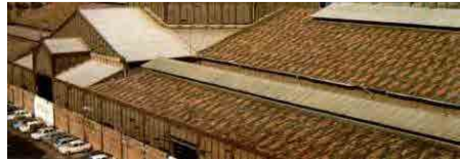
Fig. 193 Estado de las cubiertas del edificio antes de la restauración.
