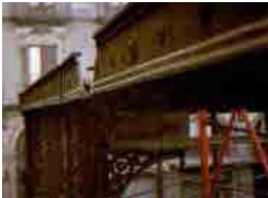
Fig. 195 Deterioro en canalones de la cubierta, 1977.
