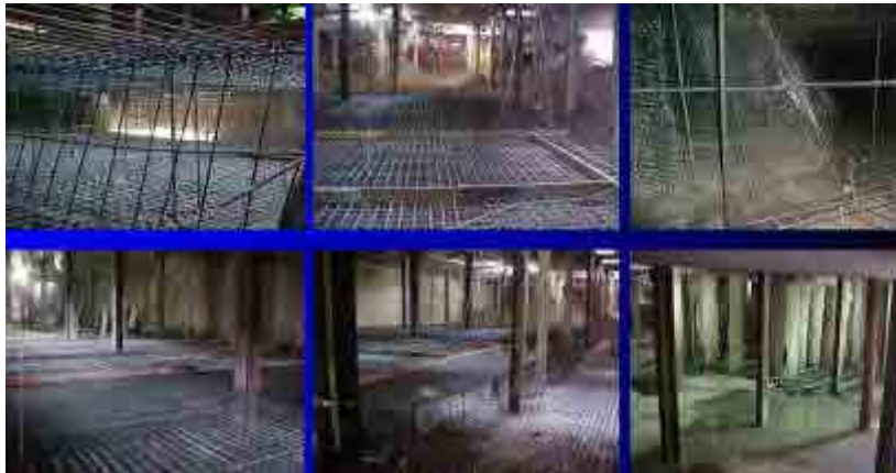
Fig. 413 Detalles de las armaduras de la losa de cimentación y su hormigonado. Fuente: MCPC
