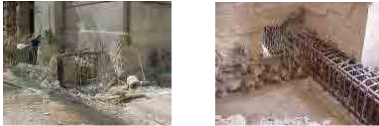
Fig. 401 Recalce de la cimentación en las portadas. Vista exterior armadura vigas y vista interior armadura vigas. Fuente: MCPC
