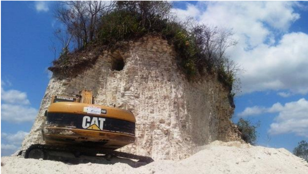
Figura 3. Las excavadoras de una compañía constructora han destruido en mayo de 2013 una de las pirámides mayas del sitio de Nohmul en Belice para extraer grava para la construcción de carreteras 15 .
