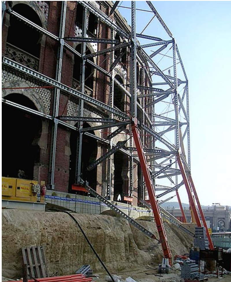
(GRAF.2: 4) Contrafuertes laterales y apeo de la fachada con sistema de micropilotes.
