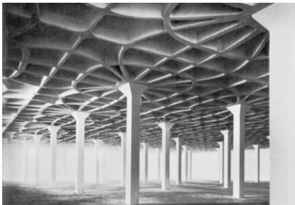
22. Pier Luigi Nervi, lanificio Gatti, Roma, 1953 il pattern del solaio segue le linee isostatiche.
