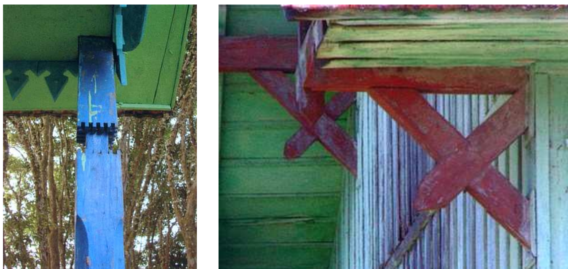
Fig. 2. 10 - Detalles de pilares, goteo
