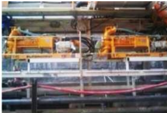
Figura 2.15. Conductos de inyección de mortero al extradós de las dovelas. Túnel de prolongación de FGC. Terrassa. (foto de la autora).
