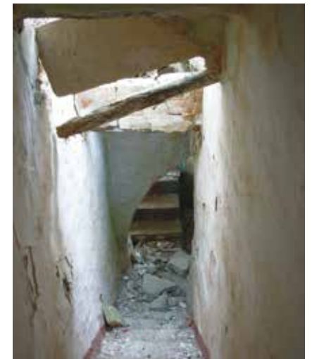
Fig. 236. Edifici esfondrant-se, Son Boter. Alaior, Menorca. Setembre de 2007.
