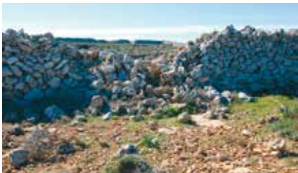
Recinte esfondrat i enderrossall
