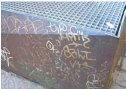
Fig. 91. 'Marcatge' dels conductes de ventilació del metro. Avinguda Paral·lel, Barcelona. Desembre de 2012.
