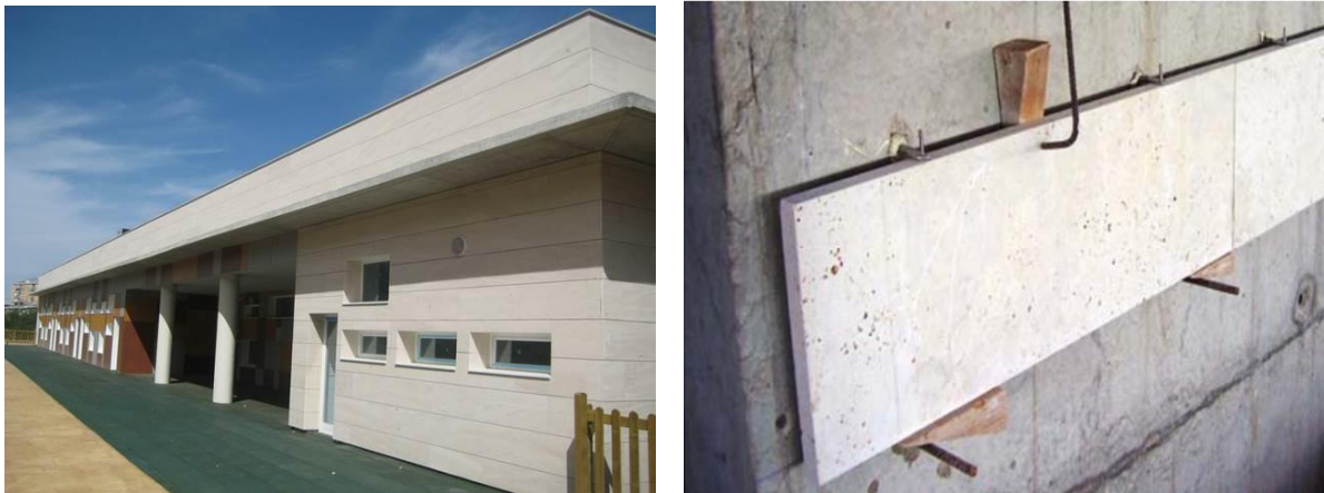
Img.2. 4 Imagen y detalle de fachada ventilada con aplacados pétreos. Utilización de piedra caliza veteada, formato: piedra serrada, medidas: 60 x 30, 60 x 40 cm, espesor: 2 y 3 cm. Escuela infantil en Ciudad Lineal Madrid (C5)
