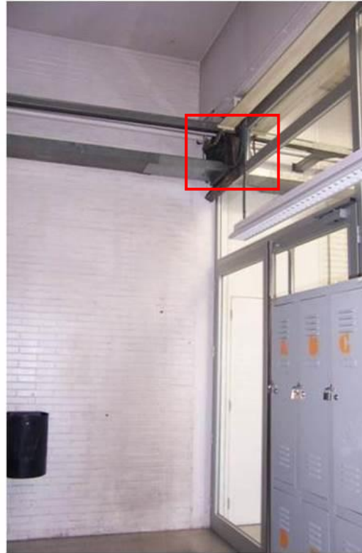
Img.B.35 Aislamiento al interior de la sala. La sala está atravesada por tuberías de instalación de la calefacción y electricidad por lo que la insonorización no era posible en su totalidad pero se utilizó lana de roca para atenuar la intrusión externa a la sala. (D)
