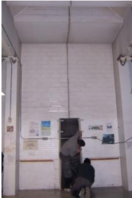
Img.B.7 Acondicionamiento previo de la sala. Colocación de bandas de lana mineral Ultravent en la junta de dilatación fijadas con cinta adhesiva (D)
