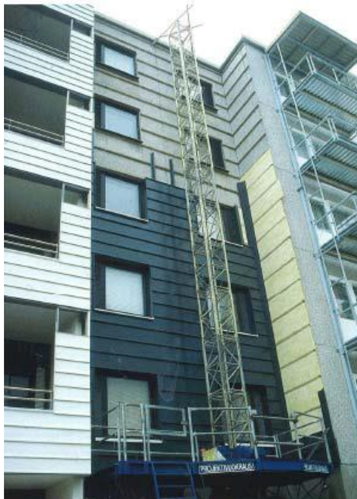
Img.1. 2 Renovación de fachada de un edificio de vivienda en Helsinki (B1)
