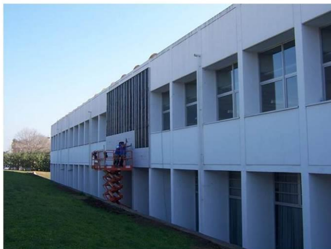
Img.B.40 Instalación Configuración (Fb). Juntas abiertas entre placas, se observa la subestructura común con los demás sistemas y la lana de roca de 40mm en toda la superficie. (D)
