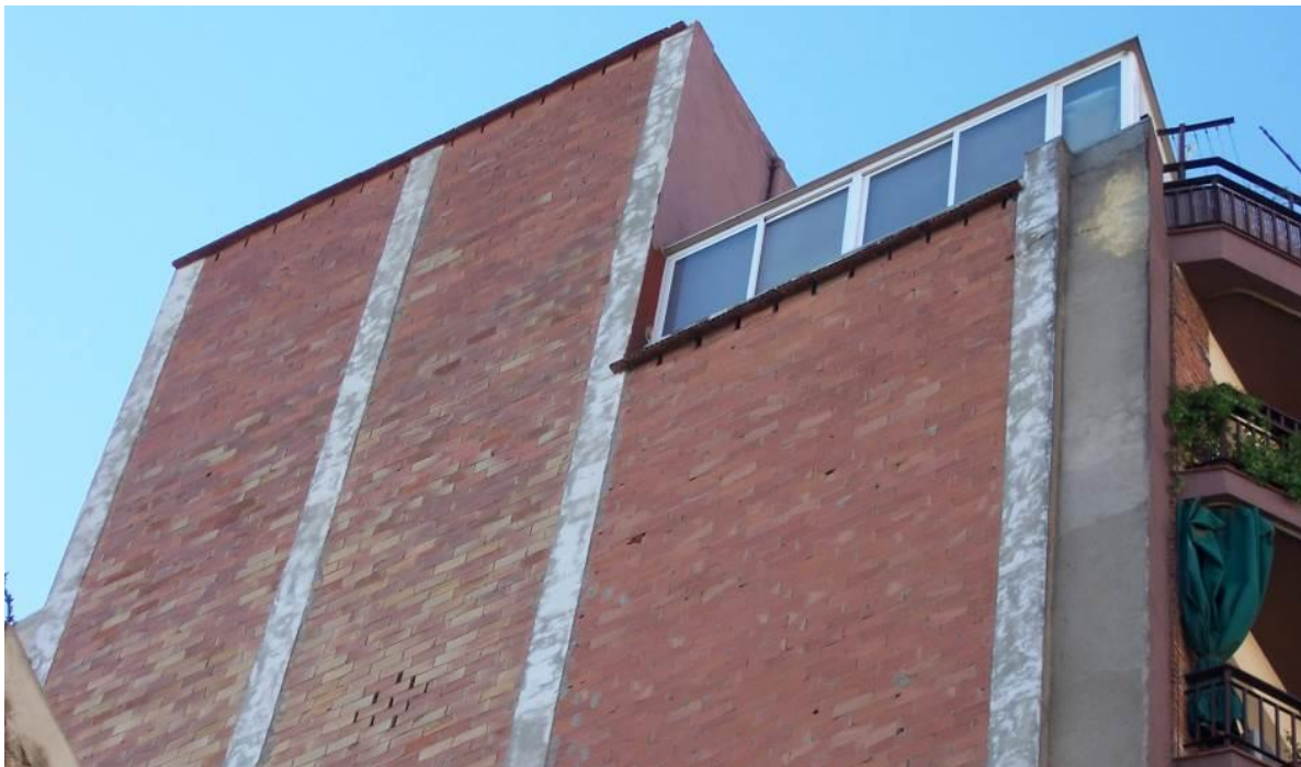
Img.A.1 Imagen tabique pluvial. En un edificio de viviendas en Barcelona España (D)
