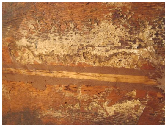
Figura 3.91. Taula de sant Miquel de Soriguerola _3910_ Reparació de la junta d'unió entre posts amb fusta i Araldit® fusta. (© BAUTISTA, I.)
