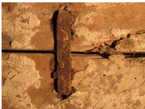
Figura 3.43. Taula de sant Jaume de Frontanyà_13_ corrosió de les grapes metàl·liques. (© BAUTISTA, I.)
