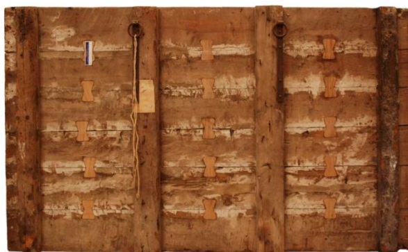
Figura 2.16. Taula de la Verge de Marinyans_Barrots travessers originals en posició vertical. (© BAUTISTA, I.)
