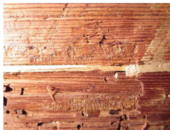
Figura 3.85. Taula de sant Bernat de Palma _4111_Tires de fusta a la separació entre posts. (© BAUTISTA, I.)
