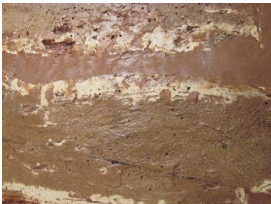
Figura 3.90. Taula de la Mare de Déu i el Corpus Christi _9919_ Reparació d'una fissura amb Araldit® fusta. (© BAUTISTA, I.)
