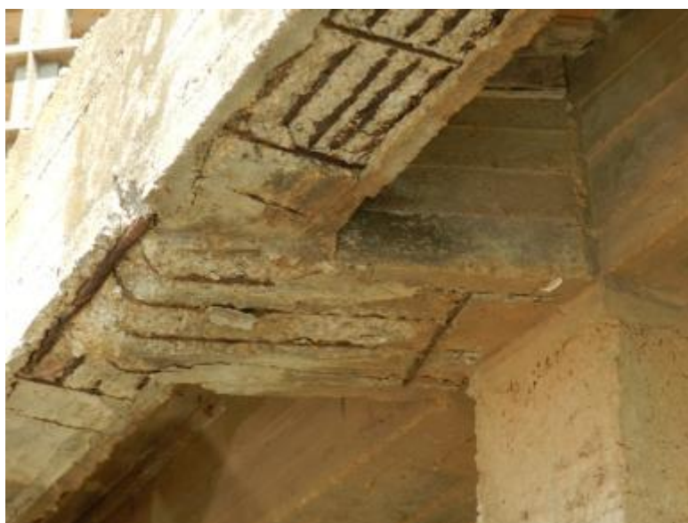
Ilustración II-8. Fuerte corrosión de armaduras
