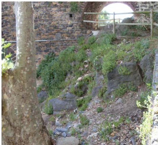
Imagen 12.7 A la izquierda: margen izquierdo y aguas abajo, rocas basálticas sobre las que se asienta el puente..
