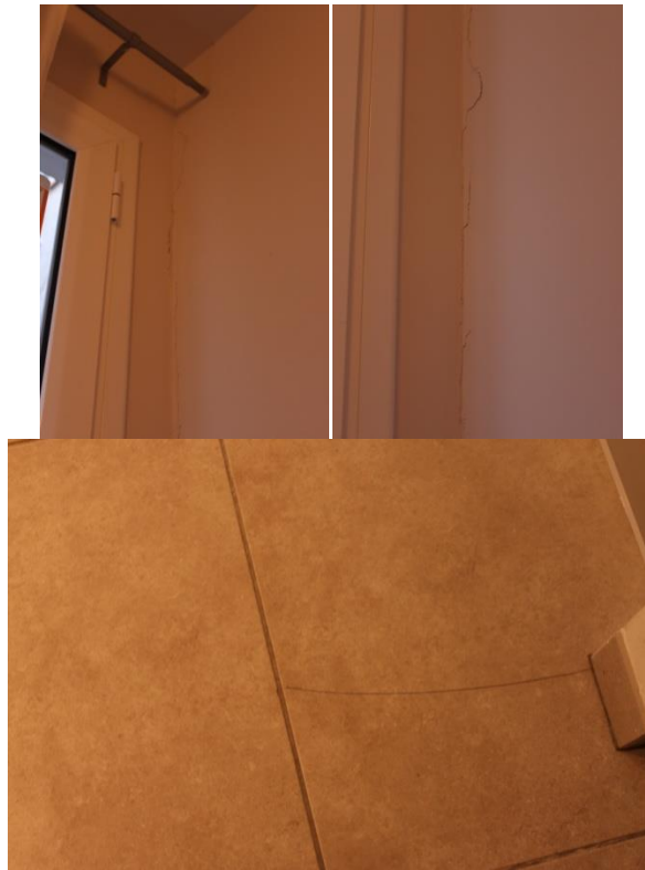
Figura 131: Esquerdas entre envà i mur de càrrega (esquerra) i esquerda per flexió de biguetes (dreta), Rosselló 210.
