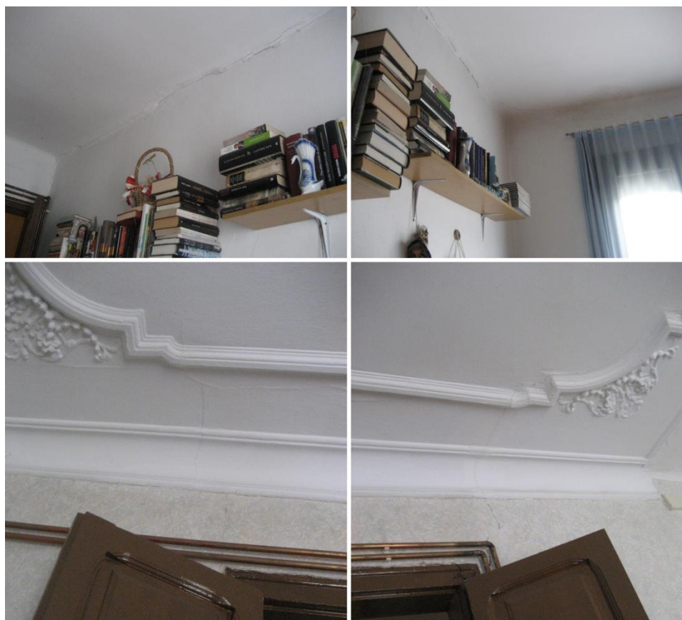
Figura 132: Fissures en envans per flexió de sostre
