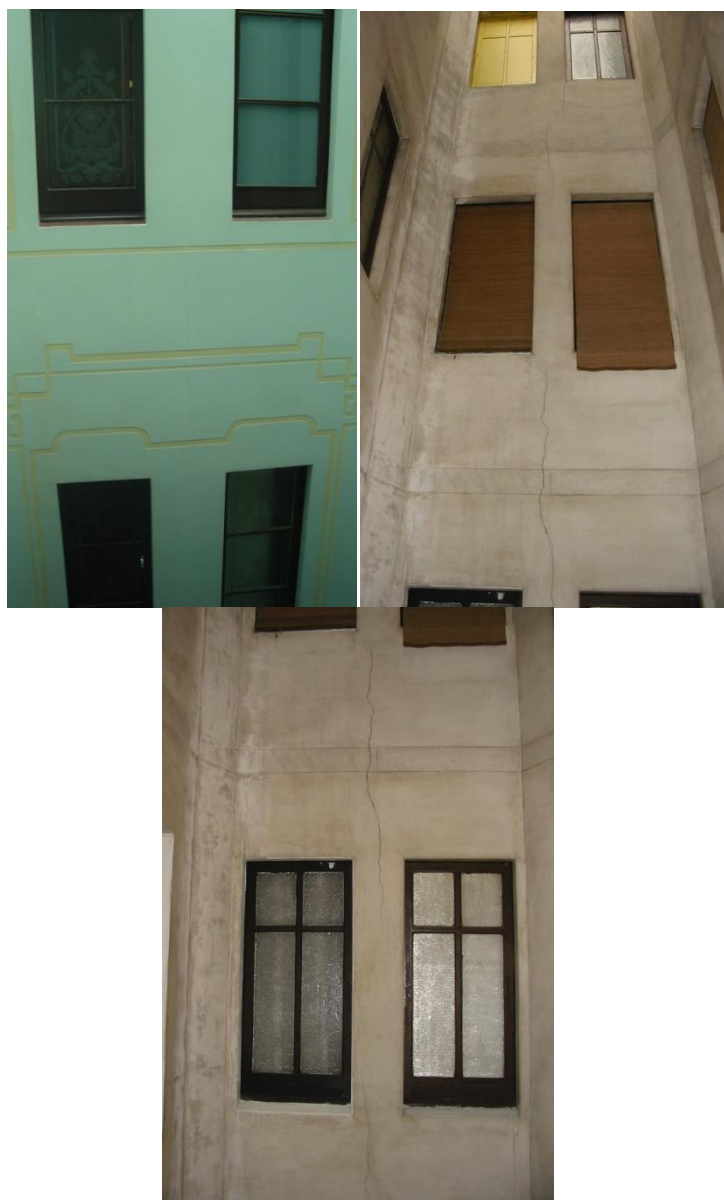
Figura 121: Esquerdes en celobert (1, Provença 363; 2 i 3, Rocafort 217)
