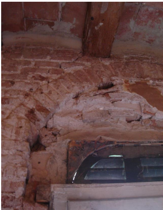
Figura 256: Esquerda sota recolzament de bigueta sobre llinda de finestra
