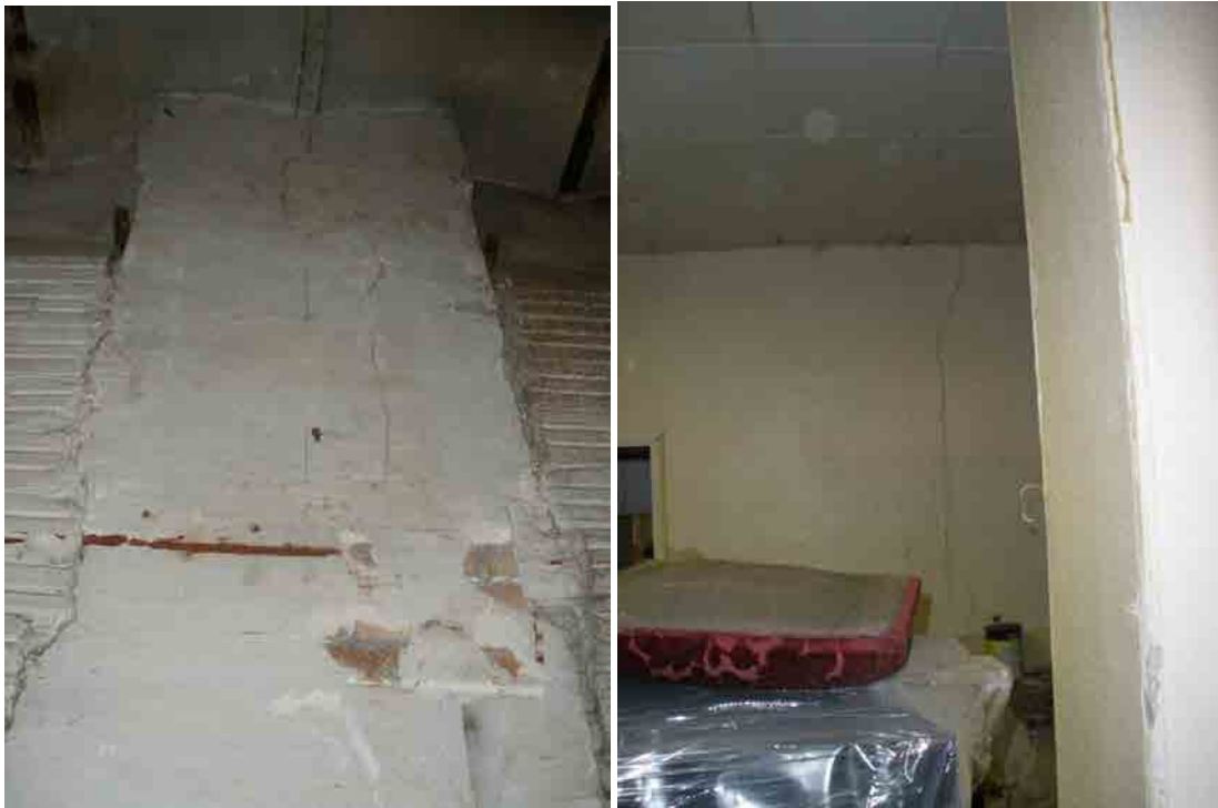
Figura 243: Esquerdes verticals a planta baixa. En pilar d'obra de fàbrica (esquerra) i en mur de pati central (dreta)
