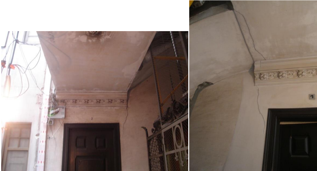
Figura 250: Esquerdes sobre portes d'accés als habitatges i a les voltes d'escala
