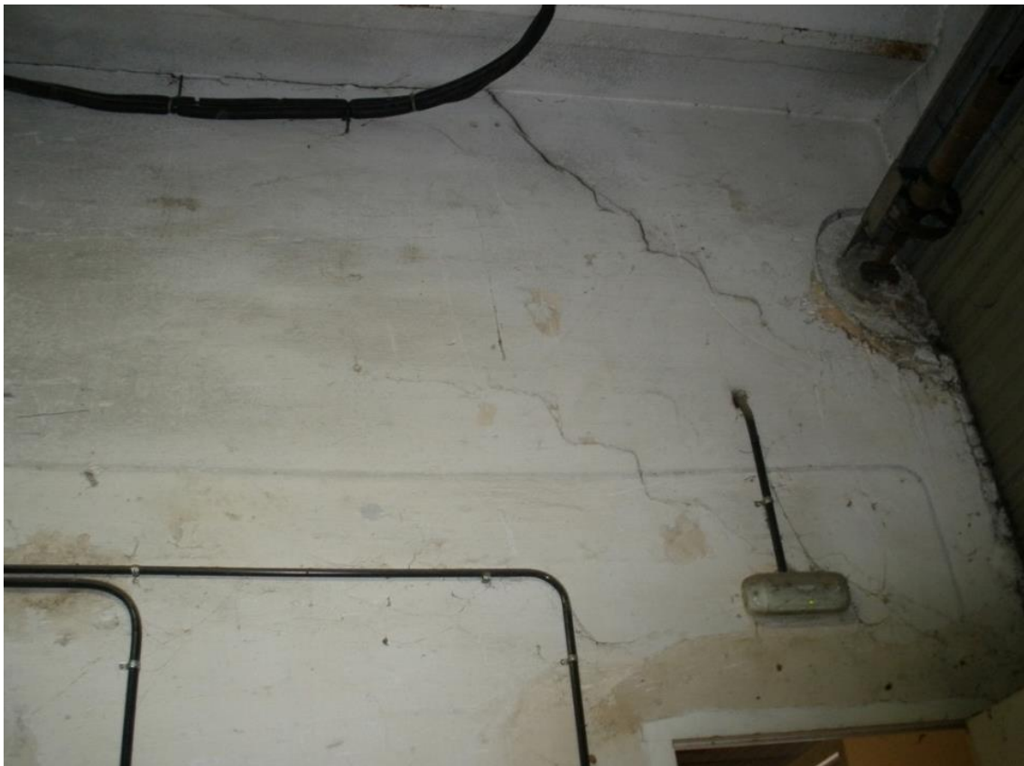
Figura 244: Esquerdes en mur de tancament a planta baixa
