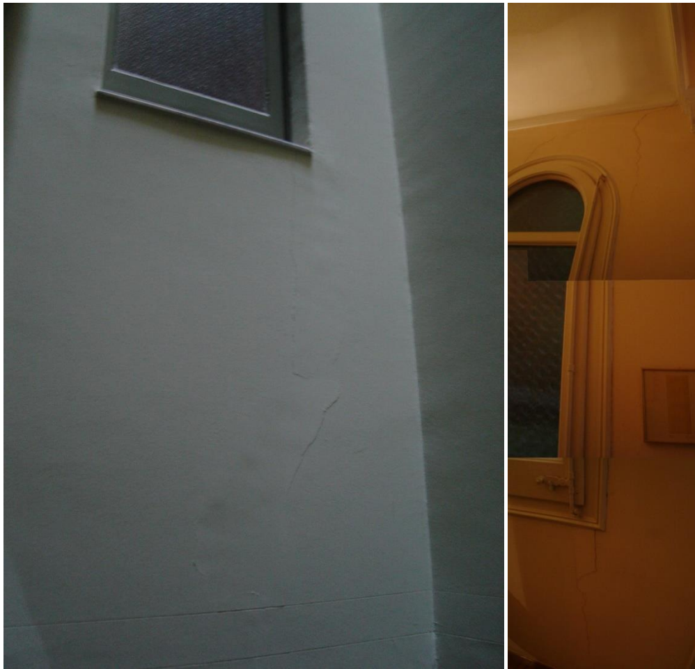
Figura 236: Esquerdes en pati central que travessen el mur
