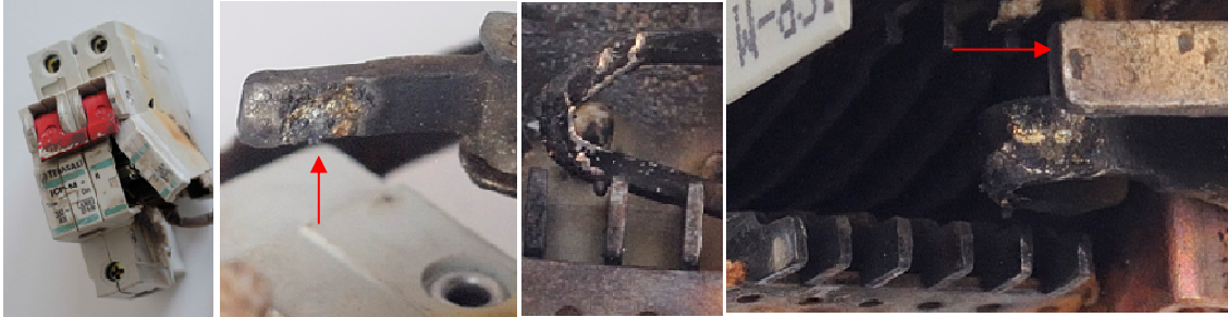
Fig.1.27. Contactes d'un ICP destruït per un curtcircuit i arc de separació. (A.f. Martí, M.).
