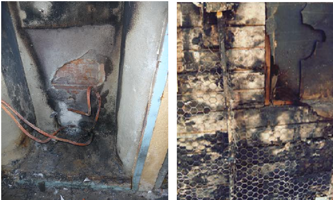
Fig.1.4 (a) Caixa general de protecció d'un edifici afectada per un curtcircuit. (A.f. Bombers de la Generalitat de Catalunya.). (b) Tanca metàl·lica de jardí afectada per una sobrecàrrega. (A.f. Graps, A.; font: v. [17]).
