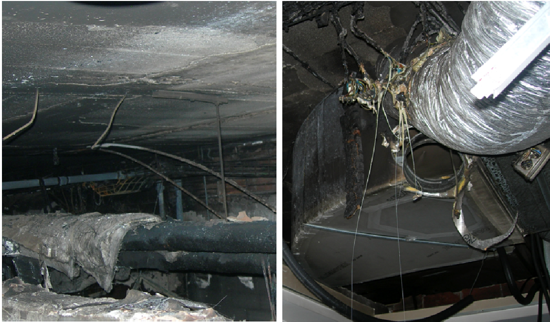
Fig.2.1 (a) Escena d'un sinistre amb partícules d'alumini adherides al sostre. (b) Conductes de climatització i cables elèctrics involucrats en el sinistre. (A.f. Bombers de la Generalitat de Catalunya).
