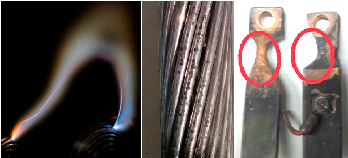
Fig.1.22 (a) Formació d'arc entre filasses d'alumini (b) Marques sobre una filassa d'alumini afectada per un arc. (A.f. Martí, M.). (c) Embarrats afectats per l'acció de l'arc procedents d'una estació transformadora. (A.f. Bosch, R.).
