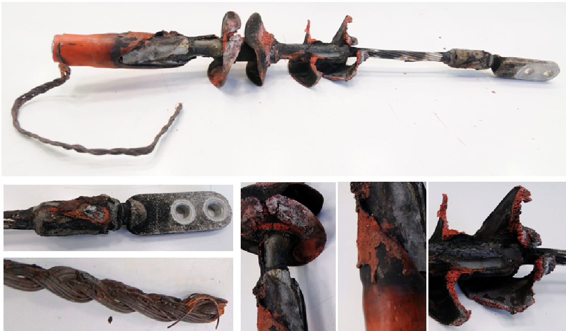
Fig.1.21 Terminal de MT afectat per un arc elèctric. (A.f. Martí, M.).
