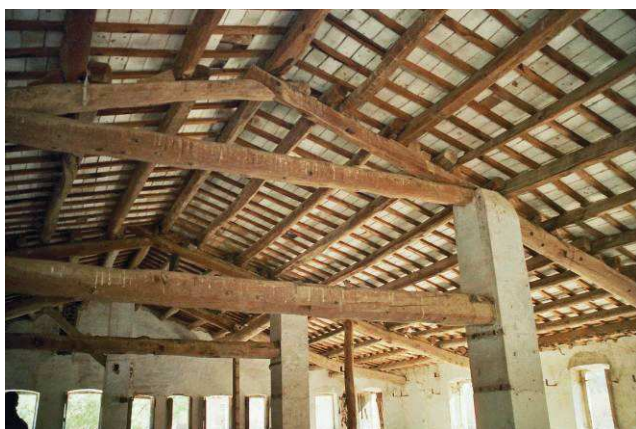
31. Conjunt d'entramat disposat sobre dues fileres de pilars laterals, a l'edifici adjunt al molí de Ca l'Esquerrà
