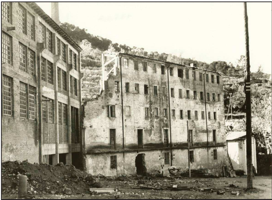
106. Procés de demolició de l'edifici, fàbrica i habitatge, de Cal Sapara (Vilaseca), mentre les naus industrials van avançant fins a ser totalment reemplaçat. (MMPC, cap a 1960)
