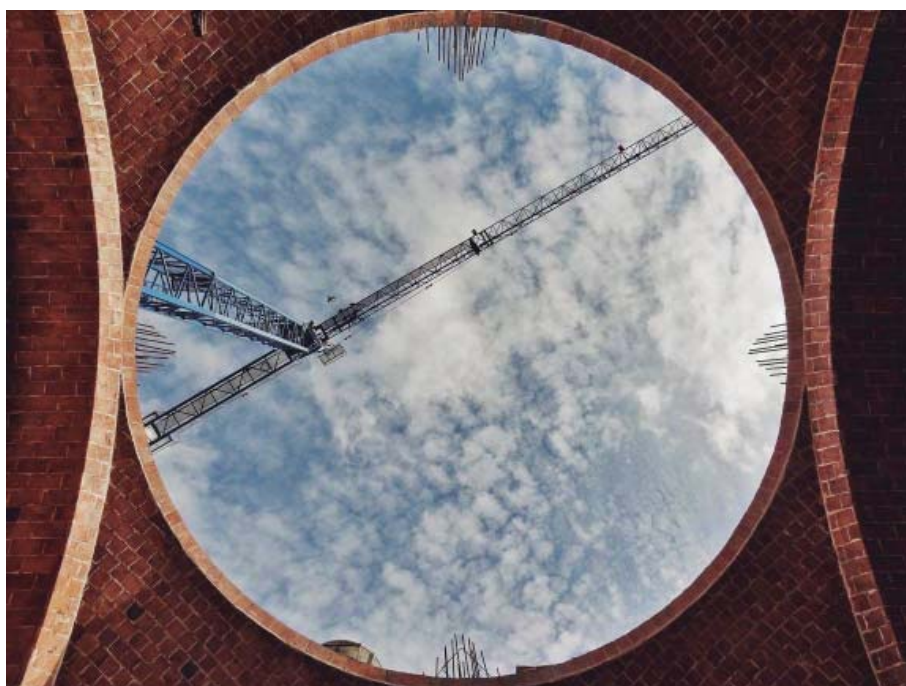
Obra en construcció de l'església ortodoxa romanesa de Barcelona. Octubre de 2015 Fotografia: Cristi Beşliu
