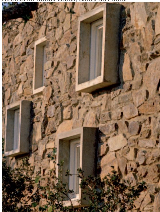
Les perforacions en el mur de la casa Fasquelle. Foto Català Roca
