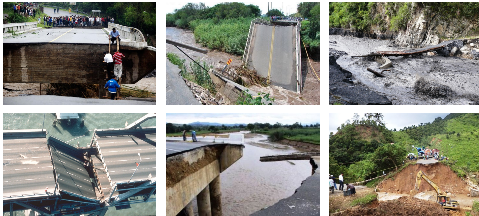
Figura 1.1: Ejemplos de puentes destruidos debido a catástrofes naturales
