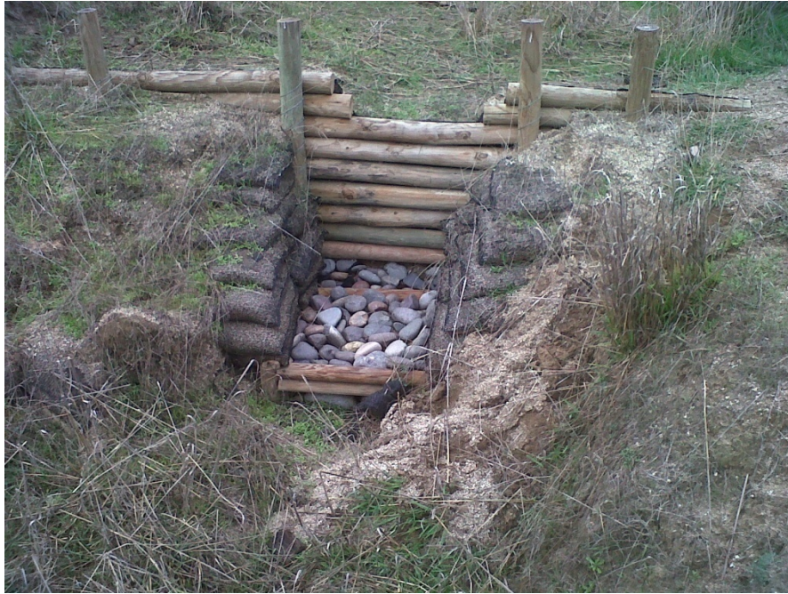
Dique de postes con disipador. Construido en una cárcava en la ladera oeste de la microcuenca, cuenta con un disipador para impedir la erosión por el impacto del flujo de agua en las temporadas invernales, además se implementaron sacos en los bordes para sostener las paredes anteriores.
