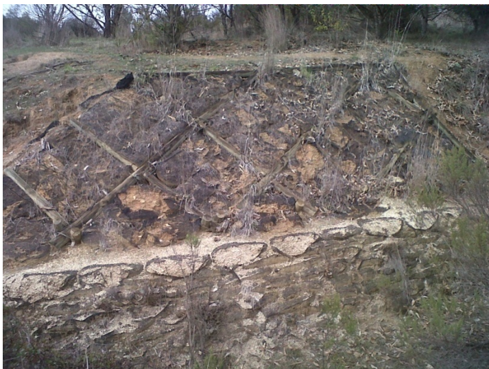
Figura 6.22. Estructura de poste de madera en la microcuenca 2. Este tratamiento resulta apropiado en laderas de baja dimensión y cuya finalidad –más que evitar la erosión en si– consiste en favorecer la implementación de biotecnias. Fuente: Captación propia
