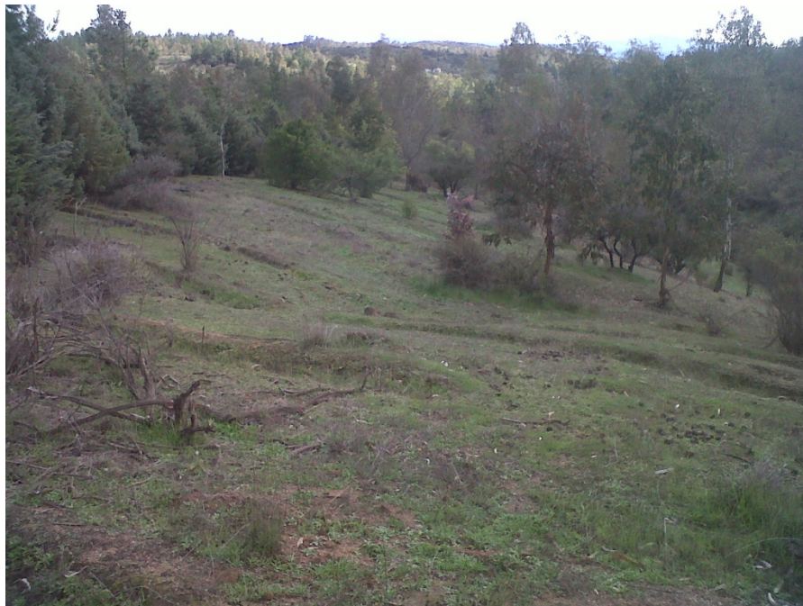
Canales de desviación. Este sistema de canales fue construido en la ladera de exposición norte en la microcuenca 2.
