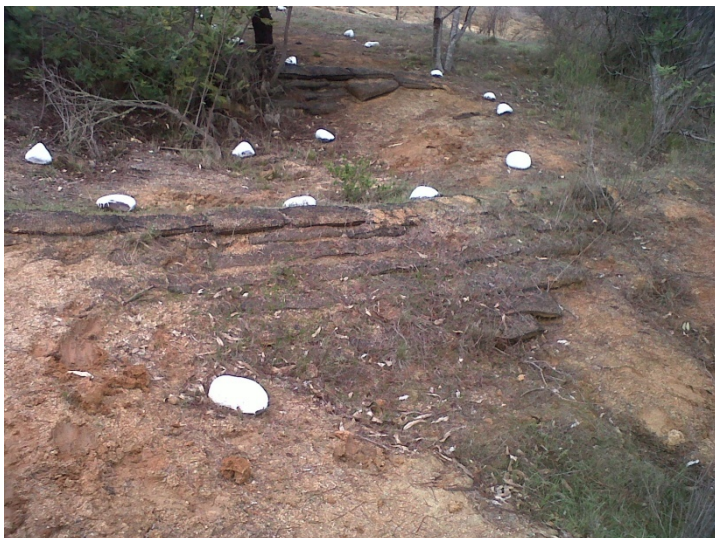
Figura 6.19. Muro de sacos rellenos en la microcuenca 2. Este tratamiento resulta apropiado para aquellos taludes donde no existan intensas presiones del suelo de la ladera. Se puede realizar en dimensiones variadas. Fuente: Captación propia.
