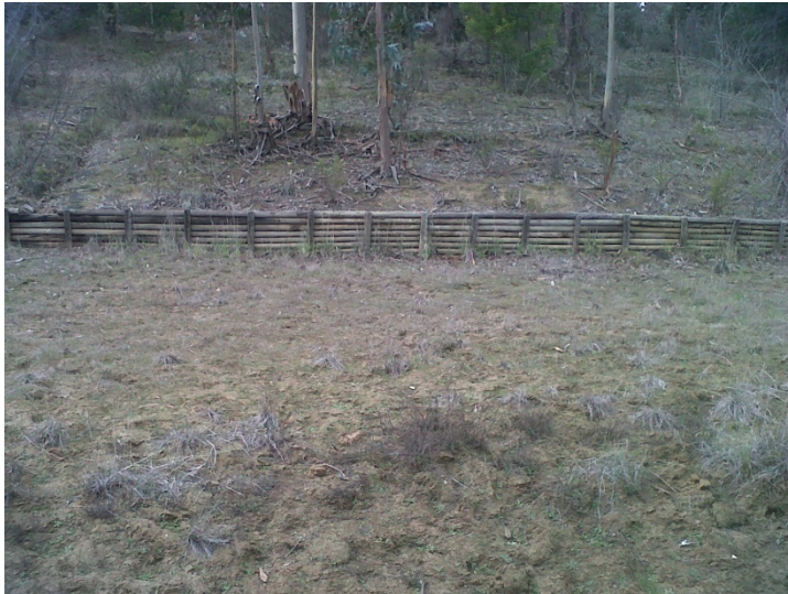
Figura 6.18. Vista frontal de muro de poste de madera en la microcuenca 3. A través de este tipo de tratamientos se pueden estabilizar áreas inestables de taludes, también amortiguar el impacto lateral de flujos hídricos en cursos de agua. Fuente: Captación propia.
