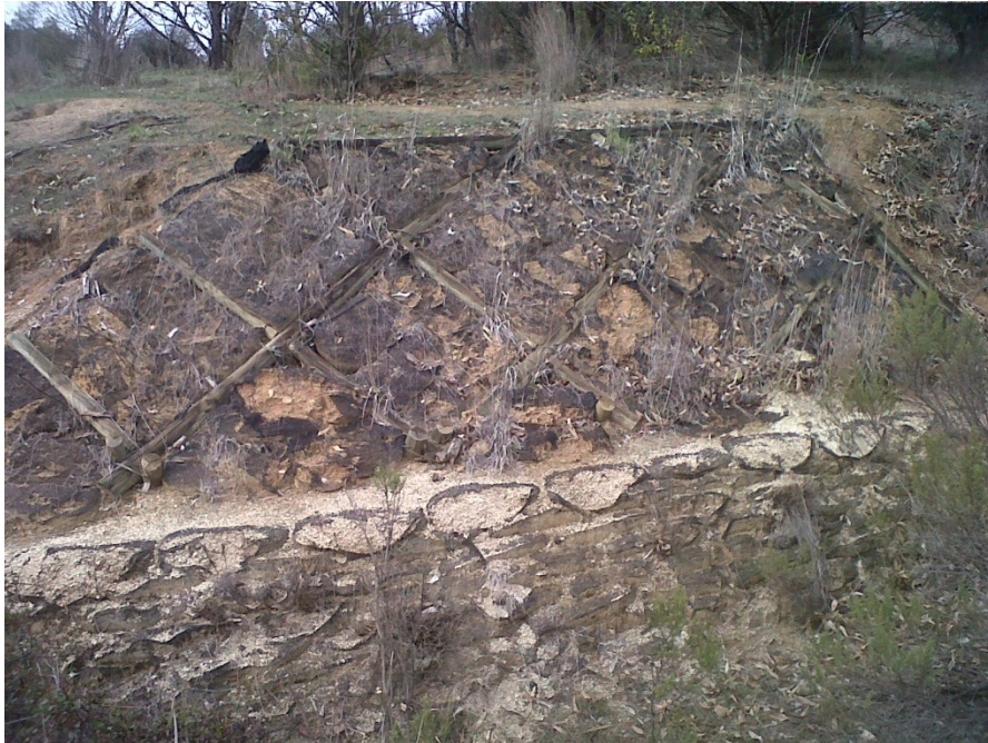
Estructura de poste de madera. Construido en la ladera de exposición norte y cercano al tranque de abastecimiento de agua, tiene como fin la estabilización de la ladera, además de utilizarse en combinación con técnicas de hidrosiembra.
