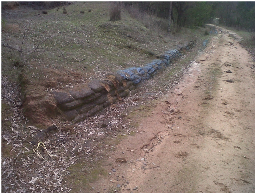
Muro de sacos rellenos. Se construyeron en la zona baja de la ladera respectiva para evitar el arrastre de material de las zonas superiores y además evitar la acumulación de material en el camino para el uso óptimo de este.
