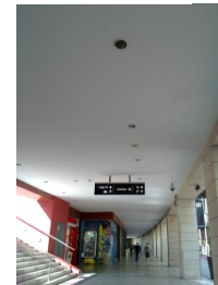
Figura IV. 47 – Techo suspendido en Pladur de color blanco. Fuente: Pedro Bento
