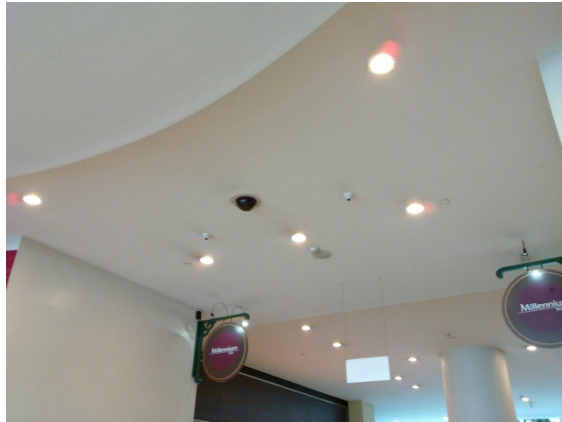
Figura IV. 278 - Cámaras de video-vigilancia Fuente: Pedro Bento
