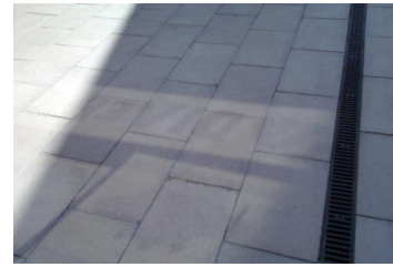
Figura IV. 41 – Losas de Granito de 60x40cm. Fuente: Pedro Bento
