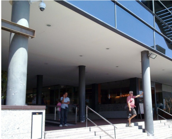
Figura IV. 272 - Cámaras de video-vigilancia Fuente: Pedro Bento
