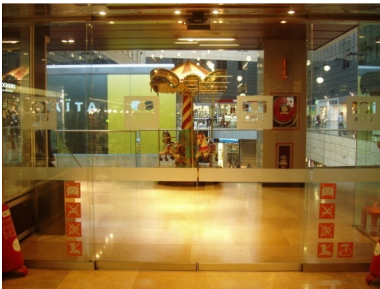
Figura IV. 269 - Puertas de Apertura Automática Fuente: Pedro Bento
