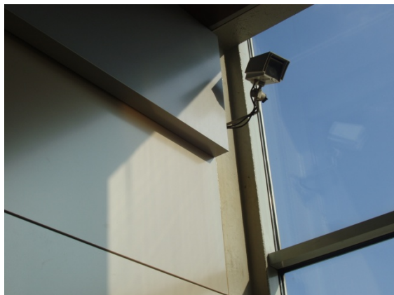
Figura IV. 266 - - Cámaras de video-vigilancia Fuente: Pedro Bento
