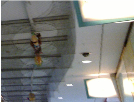
Figura IV. 284 - Cámaras de video-vigilancia Fuente: Pedro Bento
