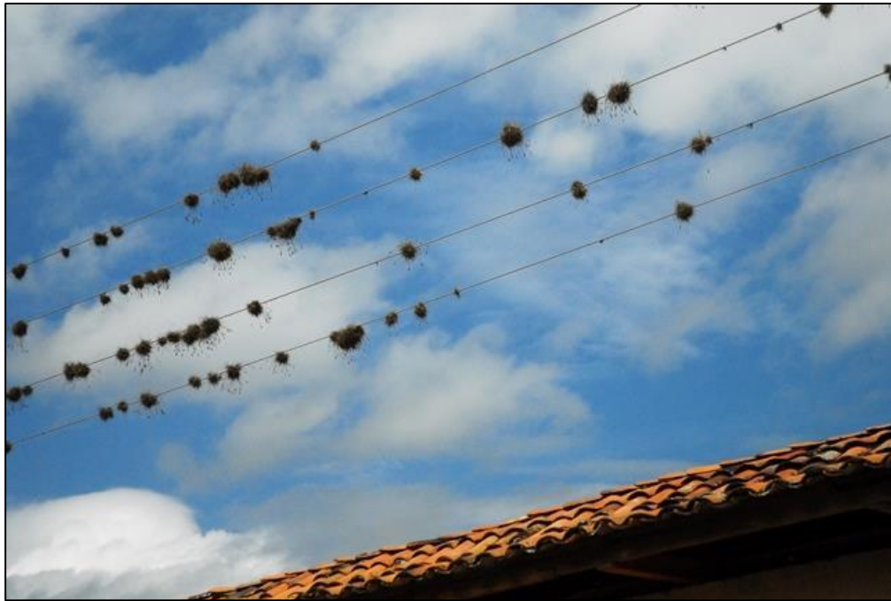
Plantas adheridas en el cableado eléctrico.
