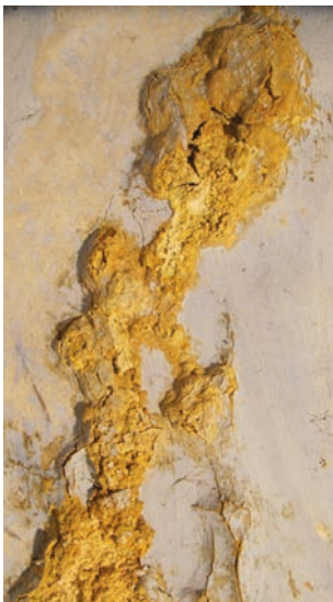
Conca absidal. Efecte de les sals en la deformació del morter. © Mercè Marquès
