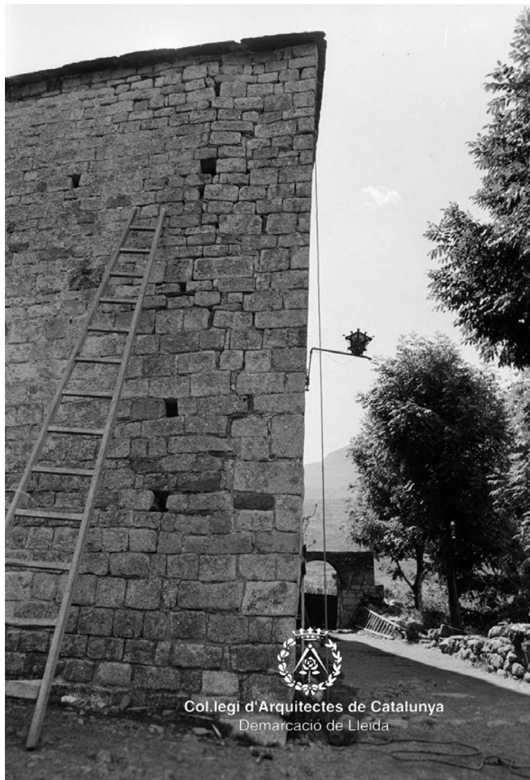
Esquerda estructural i desplom de l'angle nord-oest de l'església. Foto Arxiu Ferrant COAC Demarcació de Lleida
