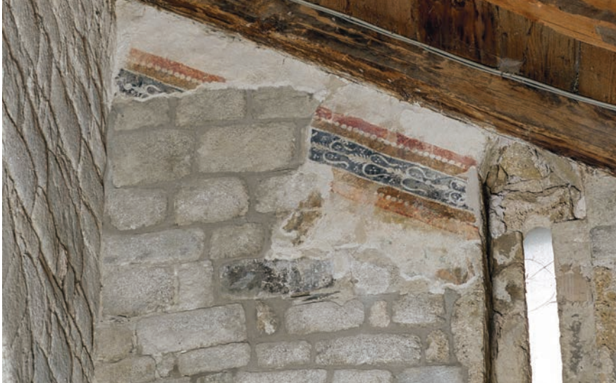
Mur de tancament de la nau sud a la zona superior del frontis. © Foto R. Ramos
