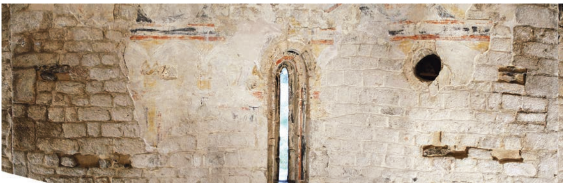
Quart nivell. Segona fase de construcció. ©Muntatge fotogràfic de J. Giribet. Calidos
