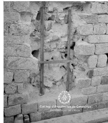
Fotografia de detall de l'interior del mur, després de extreure el primer full de carreus. Foto Arxiu Ferrant. COAC Demarcació de Lleida
