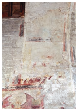
Intradós de l'arc triomfal exterior, costat nord. Aspecte de les capes profundes de les escenes dels àngels, del llàtzer i de la representació de Sant Pere. © Foto R. Ramos
