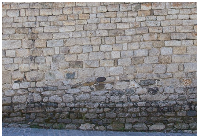
Façana nord. Dues tipologies constructives corresponent a la primera i segona fase d'edificació. © Mercè Marquès
