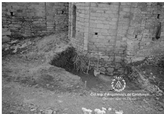
Rebaix del nivell del terra de l'exterior que deixa al descobert l'antiga construcció del mur. Anys 50 del segle XX. Foto Arxiu Ferrant COAC Demarcació de Lleida
