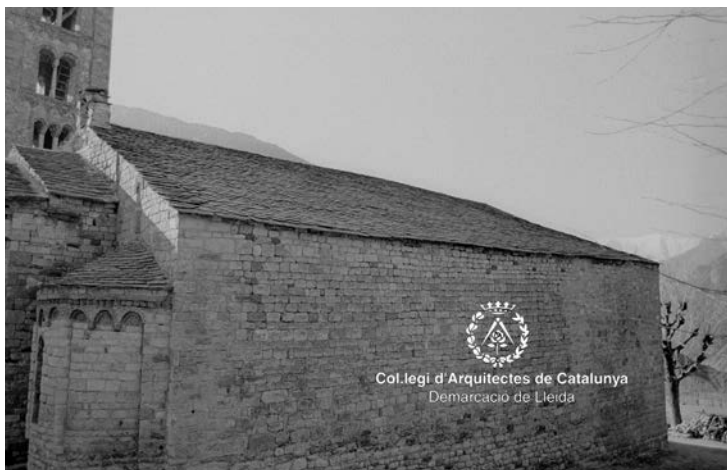
Aspecte de la façana després de la restauració arquitectònica. Volem fer notar que els orificis d'ancoratge de les bastides han estat ocultats. Foto Arxiu Ferrant COAC Demarcació de Lleida
