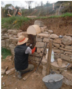
Preparació del cindri de fusta per la construcció de l'arc. Foto web.lafeixapedraseca.com
