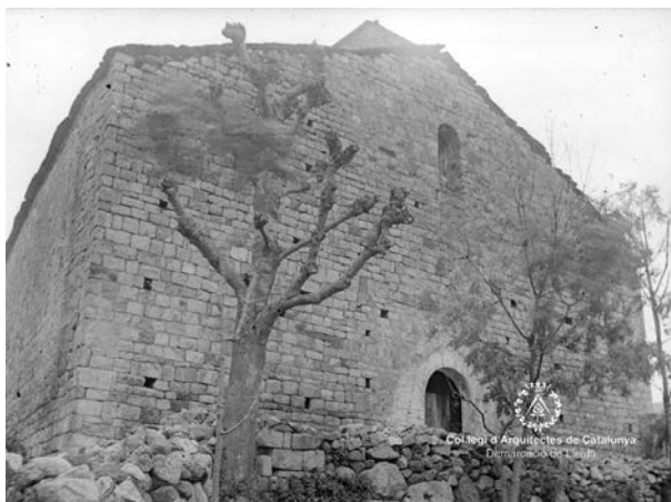
Façana oest abans de les intervencions de la DGBBAA. Es poden veure els diferents punts d'ancoratge de les bastides o bé del possible porxo. Foto Arxiu Ferrant COAC Demarcació de Lleida
