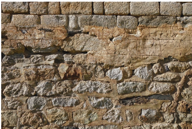
Detall de la primera decoració de junta de carreus a la façana sud. A la part superior de la imatge, hi ha una franja d'arrebossat que també dibuixa un carreuat però que és posterior a la segona fase de construcció. ©Mercè Marquès
