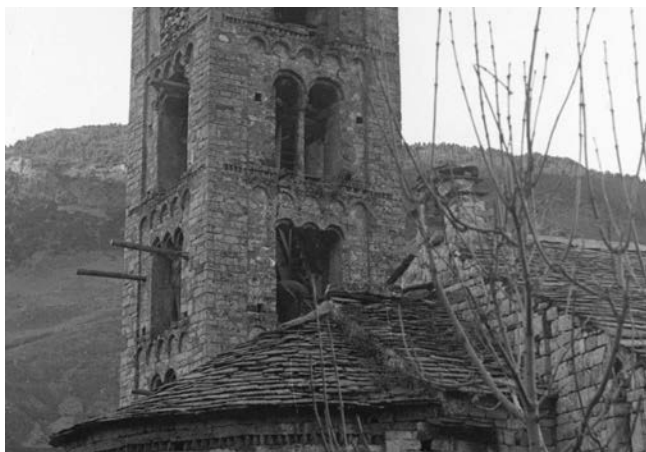
Col·locació dels taulons en els orificis de bastida de la torre per iniciar les obres de consolidació de mitjan s. XX. Foto Arxiu Ferrant COAC Demarcació de Lleida
