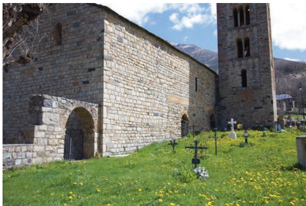
Estat actual l'any 2015 del segment de mur adherit a la façana oest que dona pas al cementiri. ©Mercè Marquès
