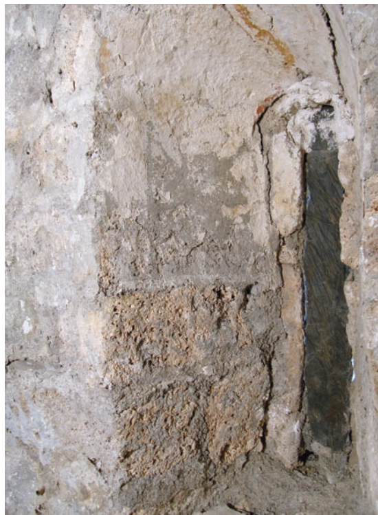
Intradós de la finestra. Per sobre de la pedra de travertí, hi ha el revestiment de la primera decoració de la junta de carreus i en un estrat superior hi ha la decoració d'emblanquinat amb la franja ocre. © Mercè Marquès
