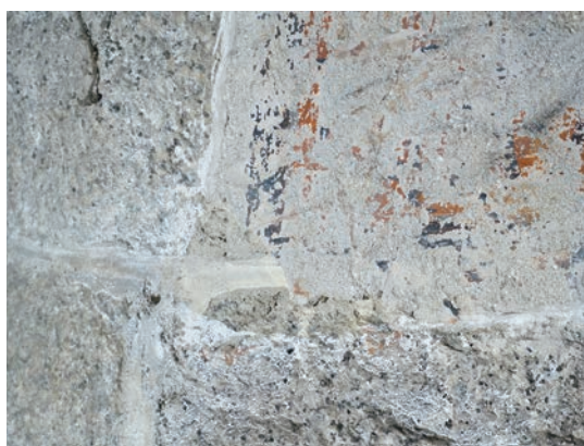
Detall de la columna 1 en la zona corresponent a la cartel·la de la data de consagració de l'església. En la cantonada inferior esquerra de la cartel·la hi ha una pèrdua del morter que tapava la decoració de junta que ha quedat reservada. Això permet veure quin era l'efecte del contrast que hi havia entre morter de color grisós i el blanc pur de la calç aplicada en la junta. ©Mercè Marquès
