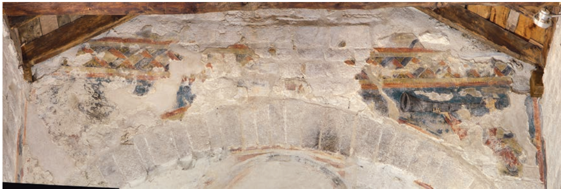
Frontis i mur de tancament de la nau central missi Dominici després de retirar la biga l'any 2011 que ocultava part de l'escena. La figura de la dreta es va recuperar sota les capes d'arrebossat i la de l'esquerra, està exposada al MNAC. © Foto J. Giribet
