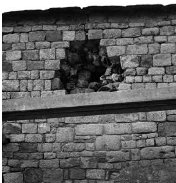
Façana sud. Aspecte de l'interior del mur. Es pot observar com el material de reblert del mur està poc cohesionat. Foto Arxiu Ferrant COAC Demarcació de Lleida
