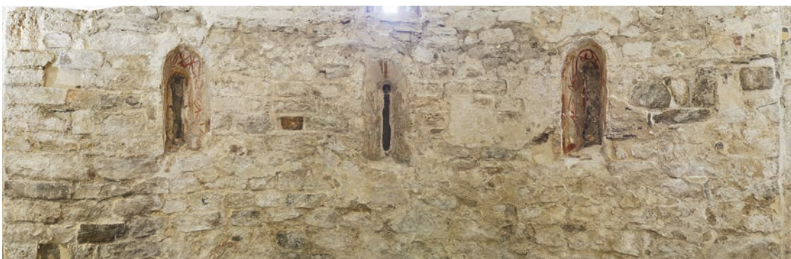
Segon nivell de l'absis. Primera fase de construcció de l'església. ©Muntatge fotogràfic de J. Giribet. Calidos
