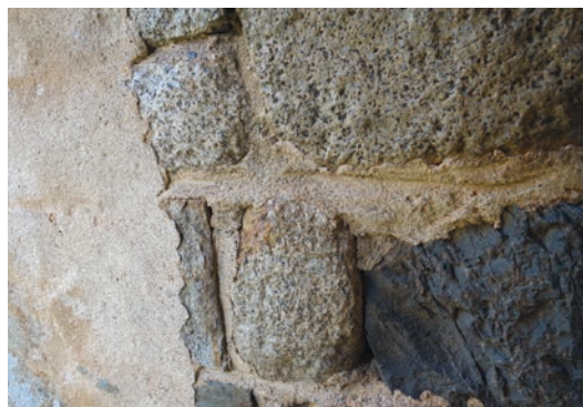
Intradós d'una finestra de la torre del campanar. Detall del rejunament en la zona que no està recoberta d'arrebossat. ©Mercè Marquès
